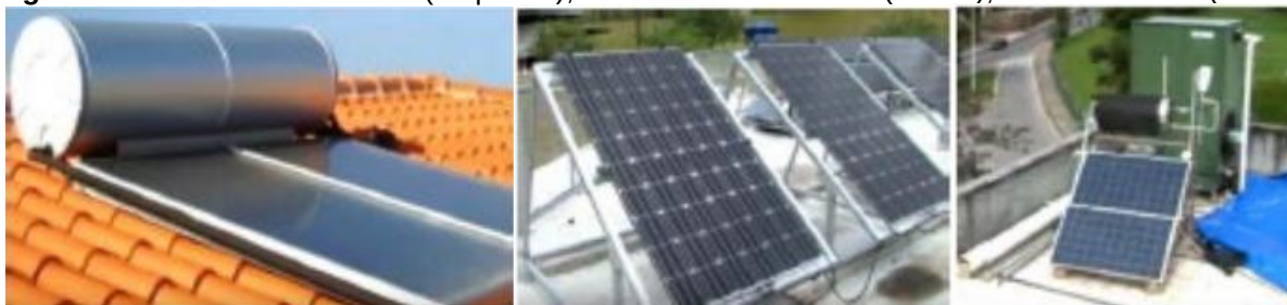
Figura 8: Coletor Solar Térmico (esquerda); Módulos Fotovoltaicos (centro); e Sistema PVT (direita)
