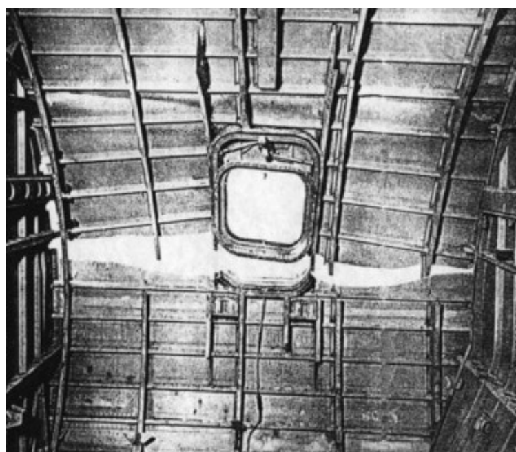
Figura 1.6: Aviões Comet: surgimento e propagação de trinca no canto de uma de suas janelas (McGinty, 2020).
