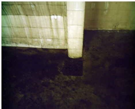
Figura 6. 16 - Piso com óleo impregnado
