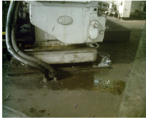
Figura 6. 21 - Fiação, óleo e resíduos
