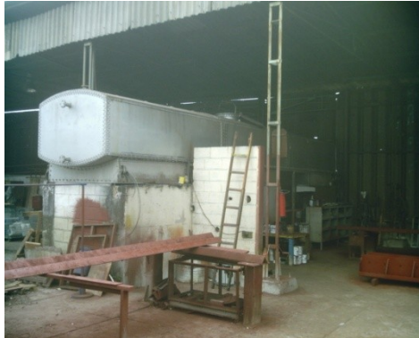
Figura 6. 4 - Tanque reserva água
