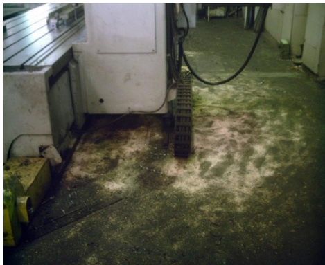
Figura 6. 13 - Serragem no piso com óleo
