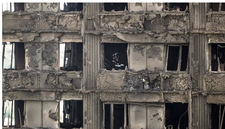
Figura 2.3: Fachada do Grenfell Tower pós-incêndio
