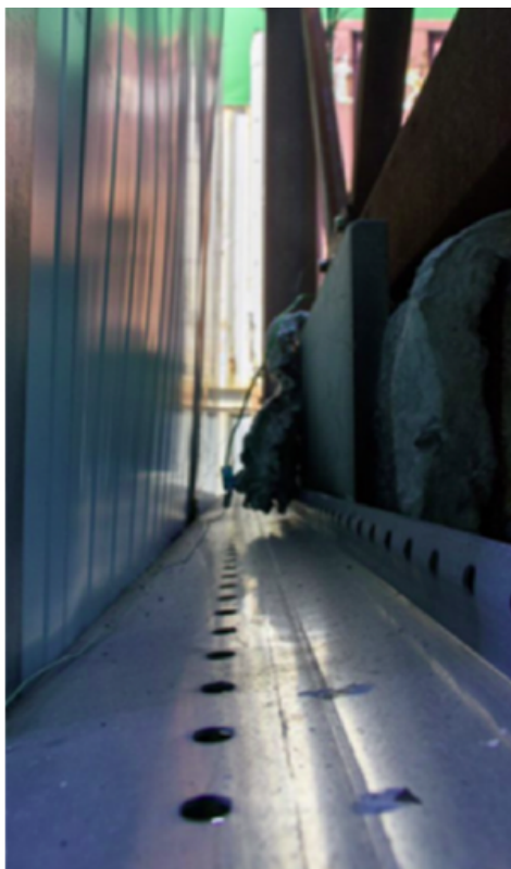
Figura 4.66: Observação pós-ensaio (E4-PIR-B) da estrutura de suporte
