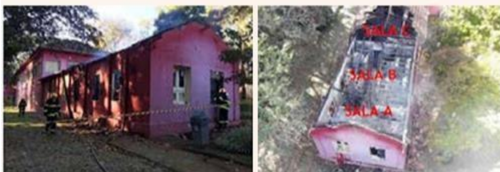
FIGURA 7: A - Vista lateral da edificação incendiada; B- Vista superior da edificação incendiada com identificação das salas.
