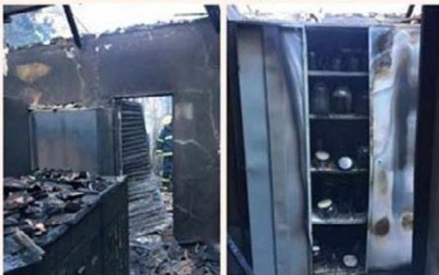
FIGURA 8: A - Vista da sala C após a contenção das chamas pelo CBMG; B - Mobiliário em aço da Sala C, com acervo da zoologia destruído pelo incêndio.
