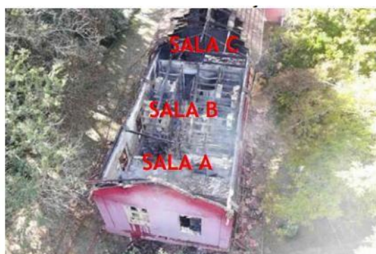
Figura 3: Vista superior da edificação incendiada com identificação das salas A, B e C.
