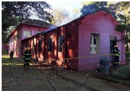
Figura 2 - Vista lateral da edificação incendiada, RT1.
