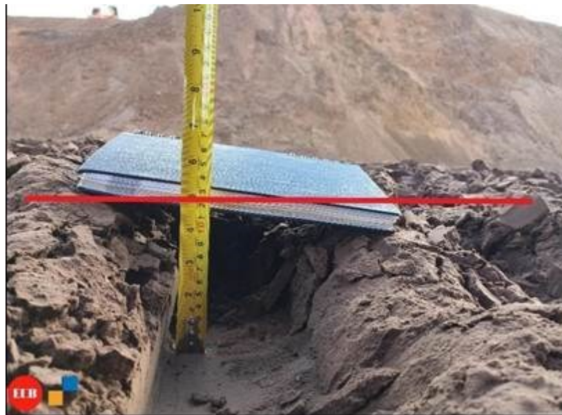
Figura 5.9 : Efeito provocado pela garra do trator de esteira na superfície da camada compactada
