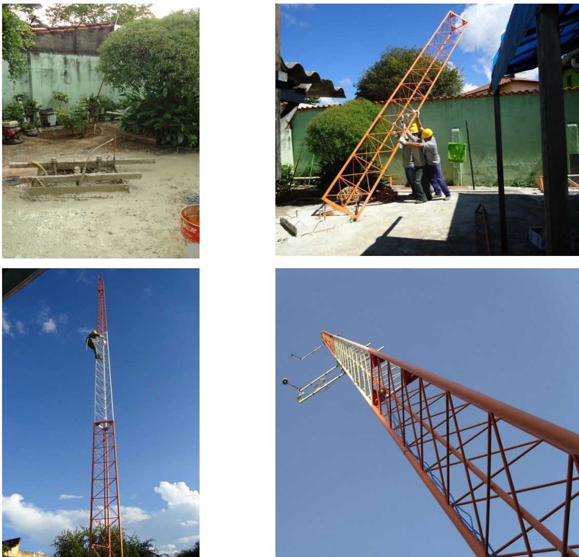
Figura 23: torre Meteorológica implantada no bairro São João Batista
