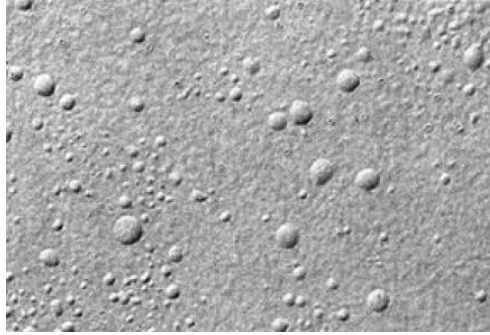
Figura 33 – Bolhas em revestimento de pintura.
