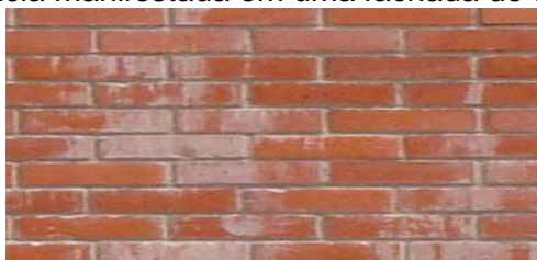
Figura 27 – Eflorescência manifestada em uma fachada de tijolo cerâmico resinado.
