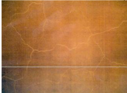
Figura 34 – Fissuras em revestimento de pintura.
