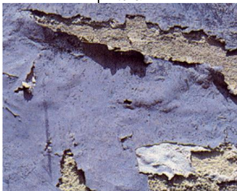
Figura 29 – Exemplo de manifestação de desagregamento em fachadas revestidas com pintura.
