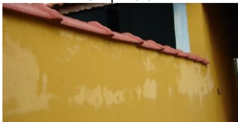
Figura 26 – Eflorescência manifestada em uma fachada de alvenaria com revestimento em pintura.
