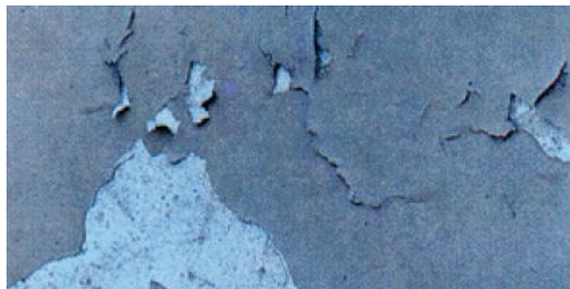
Figura 30 – Descascamento manifestado em fachada.
