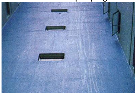
Figura 31 – Manchas causadas por pingos de chuva isolados.
