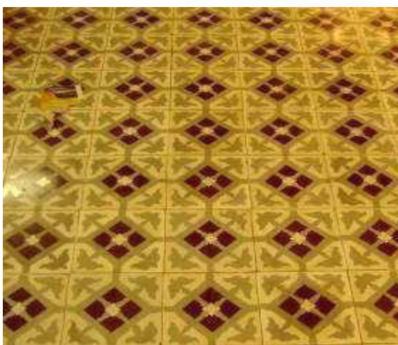
FIGURA 104 – Ladrilho hidráulico Lunardi no acesso principal do Colégio S. Coração de Jesus.
