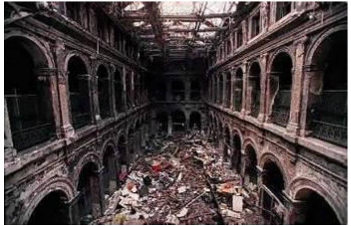
(b) Após o incêndio de 2001.
