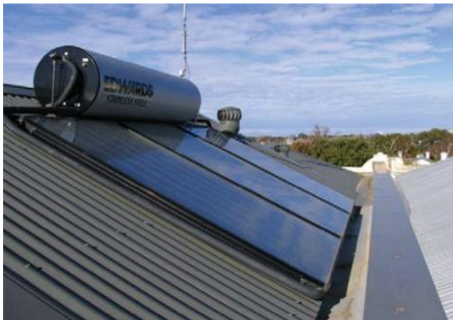
FIGURA – Painéis solares instalados em Brod Street, DSE, Austrália.
