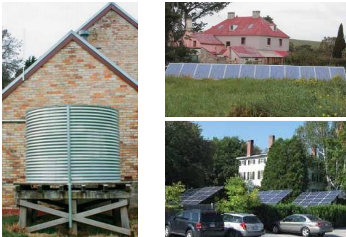
FIGURA – Exemplos impactantes de instalações de reservatório de água e painéis solares.
