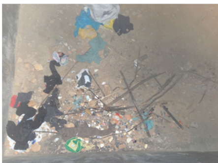
Figura 3. Lixo no interior da estrutura inacabada da obra de construção de um sistema de esgotamento em SPJ
