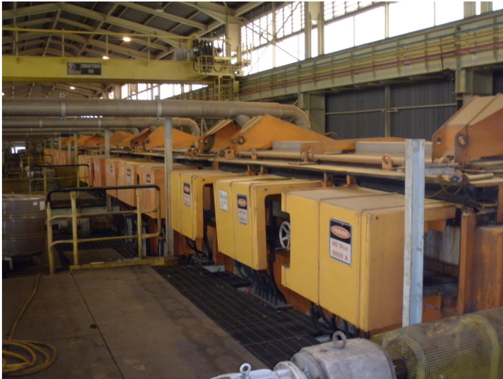
Figura 2.11 - Vista lateral dos tanques para decapagem eletrolítica.
