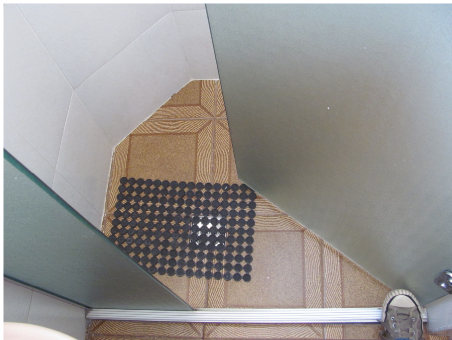
FOTO 106: Residência Raquel - abertura da porta do boxe do banheiro social - primeiro pavimento.
