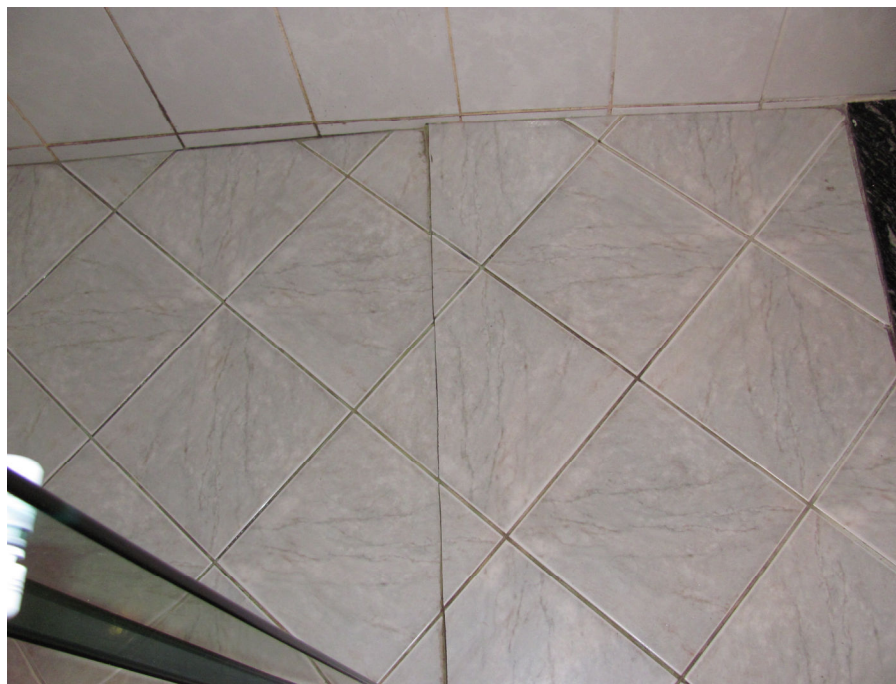
FOTO 04: Residência Roberto - detalhe do desnível do boxe do banheiro social
