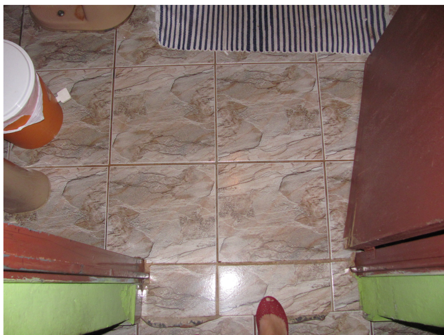
FOTO 117: Residência Pedro - detalhe da largura da porta do banheiro.
