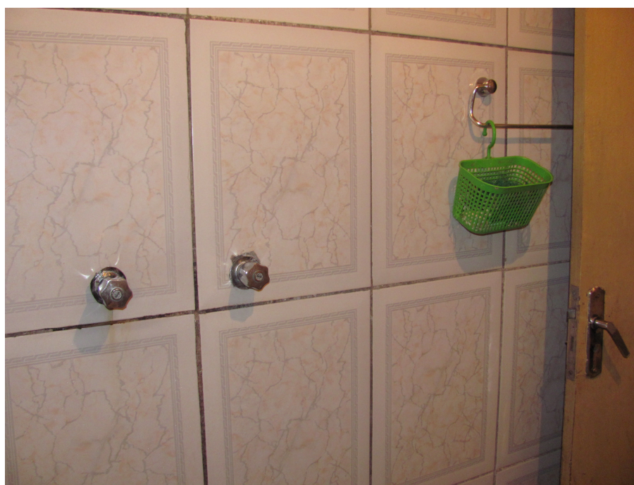
FOTO 71: Residência Leandro - detalhe do registro e do porta toalha.
