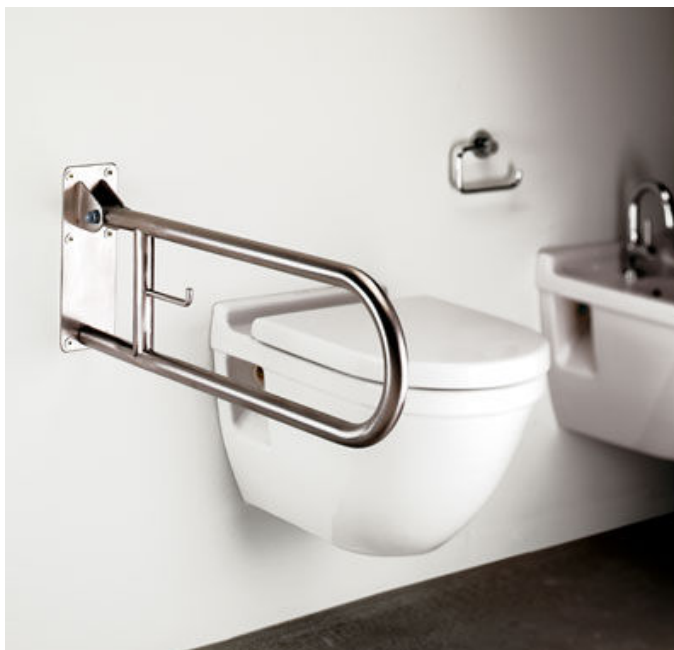
FIGURA 2: Exemplo de bacia sanitária acima do piso acabado, mas sem barras fixas na parede do fundo e sem espaço suficiente para transferência
