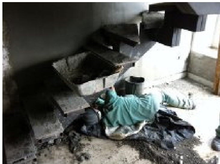
Figura 2.2.6: Ergonomia inadequada de trabalho - Funcionário executando reboco em parede. Arquivo pessoal – DEZ/2012.
