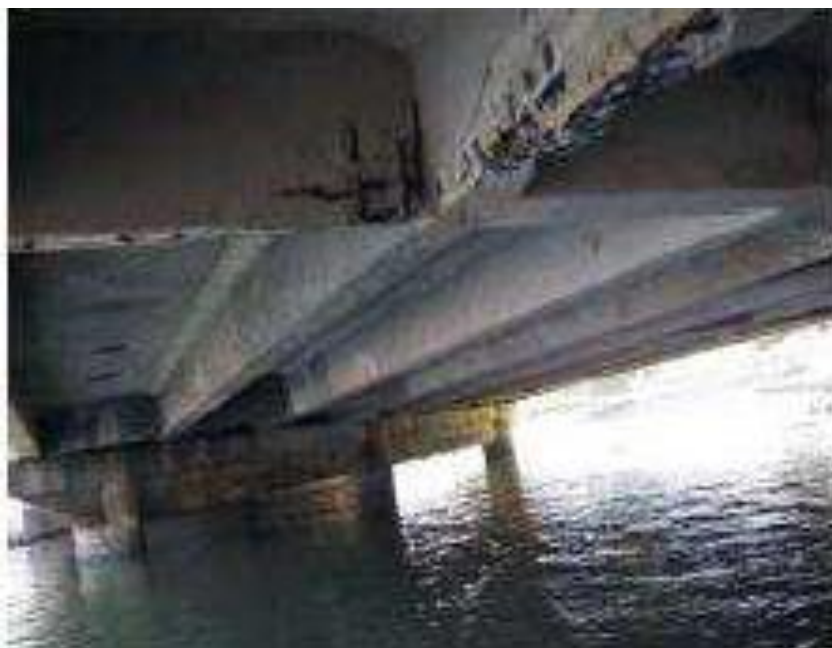
Figura 5.10 - Fissura causada pelo ataque de cloreto. Fonte: Helene (2006, p.)
