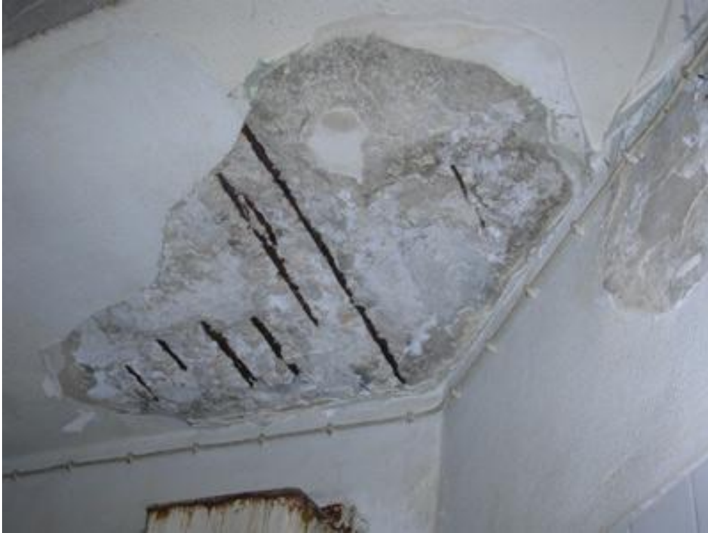
Figura 6.2 - Corrosão de armaduras Fonte:Internet
