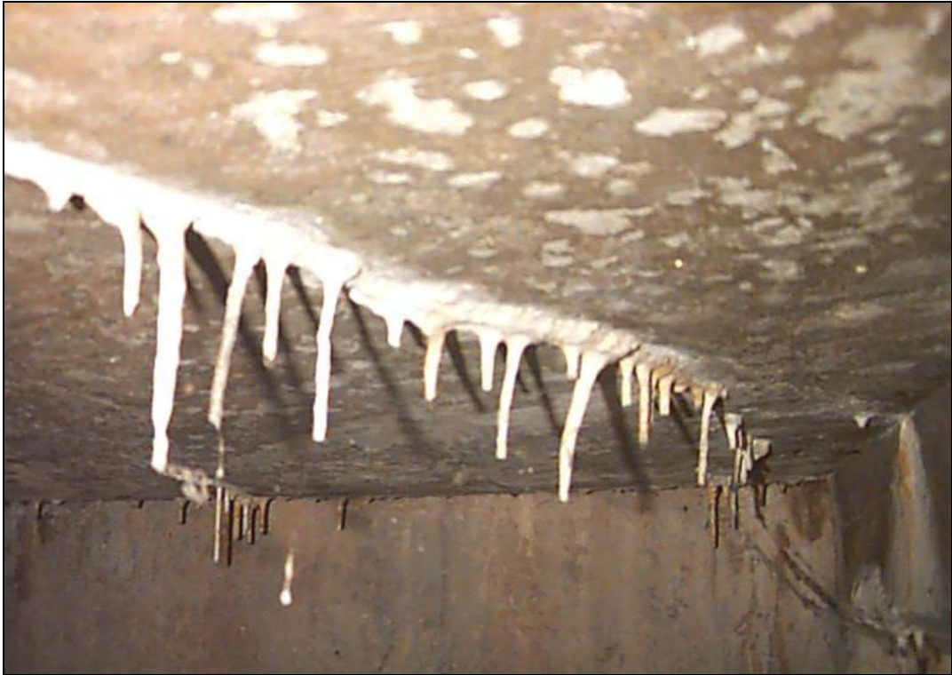
Figura 6.4 - Eflorescência do Concreto. Fonte: Internet
