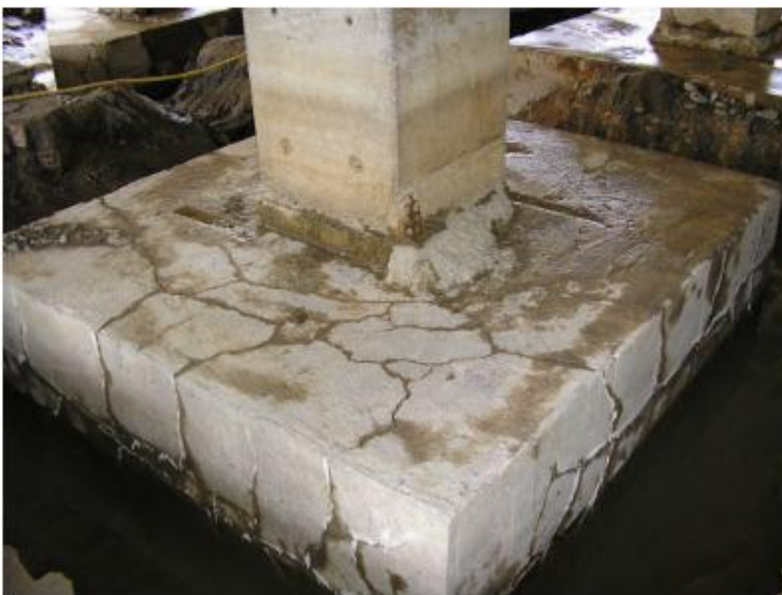
Figura 5.9 - Bloco de fundação com padrão de fissuração típico de RAA
