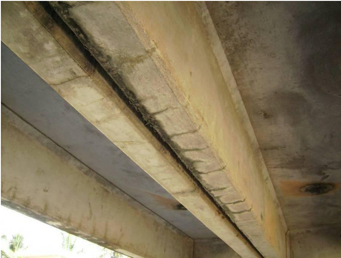
Figura 6.1 - Fissuras Fonte: Aguiar J E
