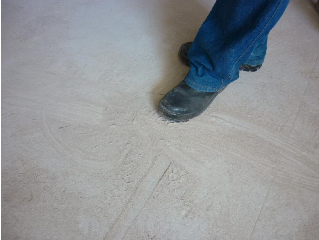
Figura 6.3 - Desagregação do Concreto. Fonte: Aguiar, JE (2012)
