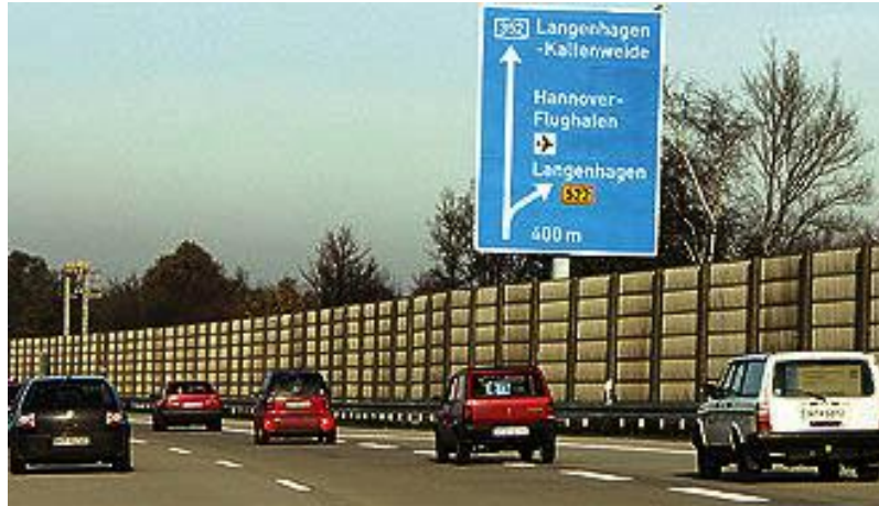
Figura 6 – Barreira acústica em estrada alemã Fonte: www.revistatechne.com.br
