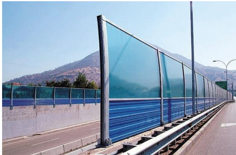
Figura 7 – barreira acústica em acrílico Fonte: www.indac.org.br
