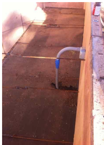
Figura 40 Instalação elétrica embutida
