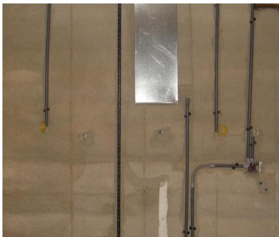
Figura 39 Instalação elétrica externa
