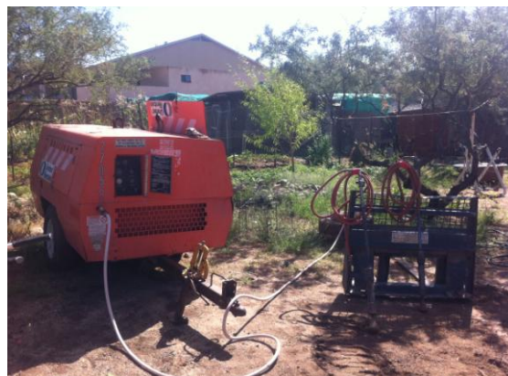
Figura 33 Compressor de ar
