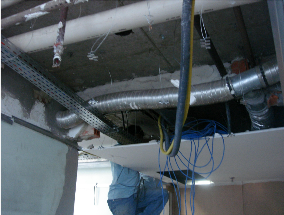
Fig. 16 – Foto dos dutos de ar no entreforro da circulação, 2010
