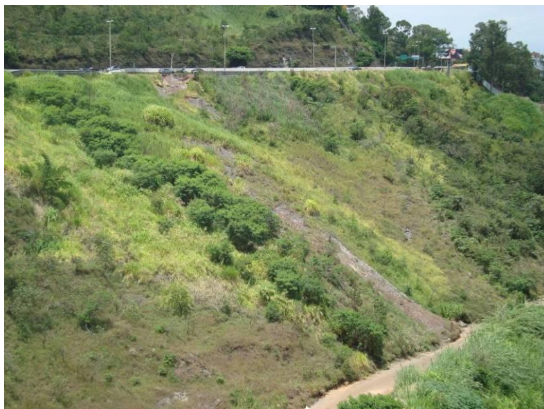
FIGURA 4.12- Talude Planetóides abaixo da BR 356. Cicatrizes de ruptura no topo e na base (Fevereiro/2010).
