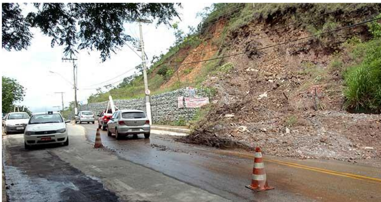
FIGURA 1.3- Corrida de detritos na Rua Patagônia, região Centro-Sul de BH, em 05-01-2011 ( http://www.em.com.br/app/noticia/gerais/2011/01/05/interna_gerais,201836/cratera-e-deslizamento-de-barranco-interditam-vias-da-regiao-centro-sul-de-bh.shtml )
