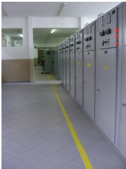
Figura 6.3 – Cubículos de distribuição em 13,8 kV.
