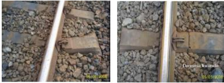
FIGURA 3.22 - Dormentes de aço fraturados. (FONTE – AAR, 2010).
