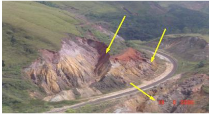
FIGURA 3.26 – Exemplo de instabilidade de taludes (FONTE - ANTF, 2009).
