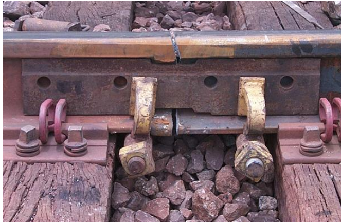
FIGURA 3.31 –Trilho quebrado abrindo o circuito de via. (FONTE - ANTF, 2010)
