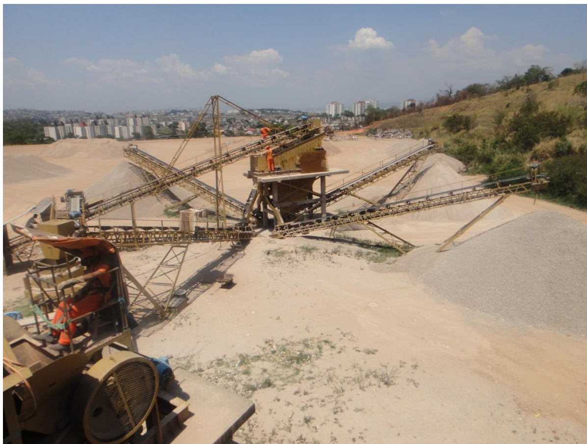
Figura 5.8: Estação de Reciclagem de Entulho (ERE) da BR040
