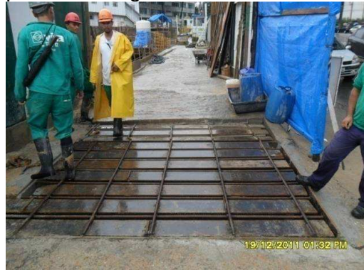
Redimensionamento do lava rodas. Ampliação da grelha metálica e da caixa de decantação.
