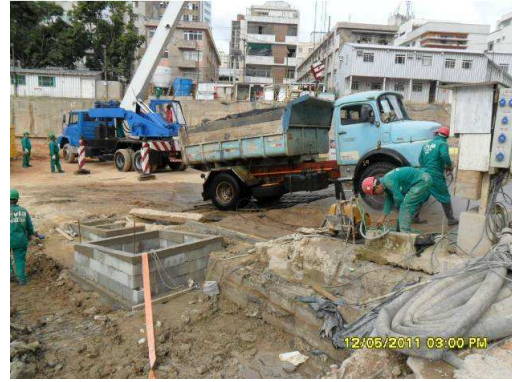
Recuperação da caixa separadora de água e óleo - CSAO
