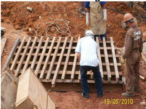
Grelha metálica para tráfego de veículos.
