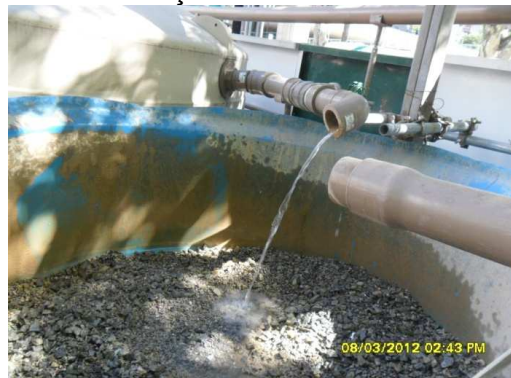
Caixa filtro do sistema de decantação. Efluente abaixo de 1ml/L descartado para via pública.
