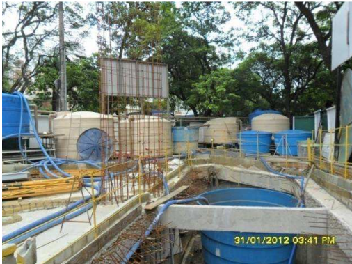
Sistema de decantação.
