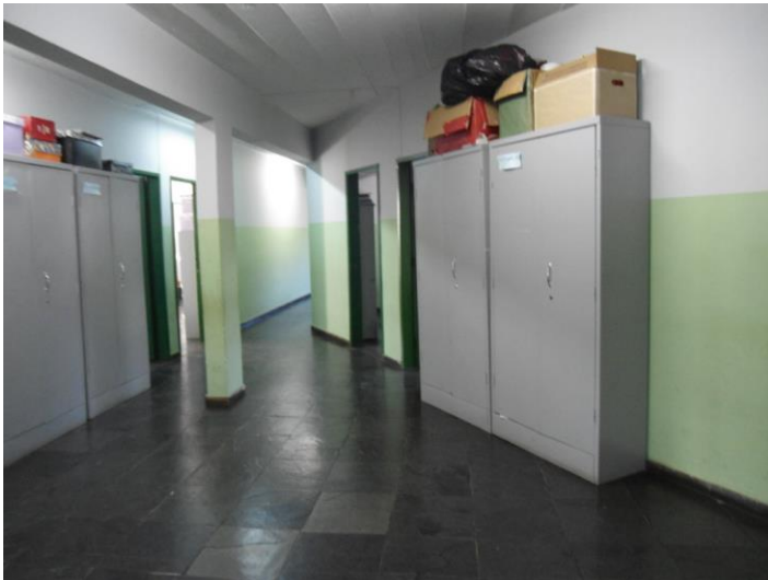
Anexo 15 – Vão de acesso às salas de atividades do 2º andar e da biblioteca
