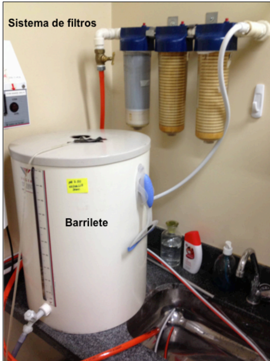
Figura 11. Sistema de pré-filtros e tratamento da água em barriletes.
