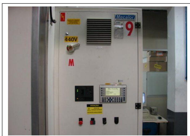
FIGURA 57 – Câmara climática MECALOR – Painel de Controle.
