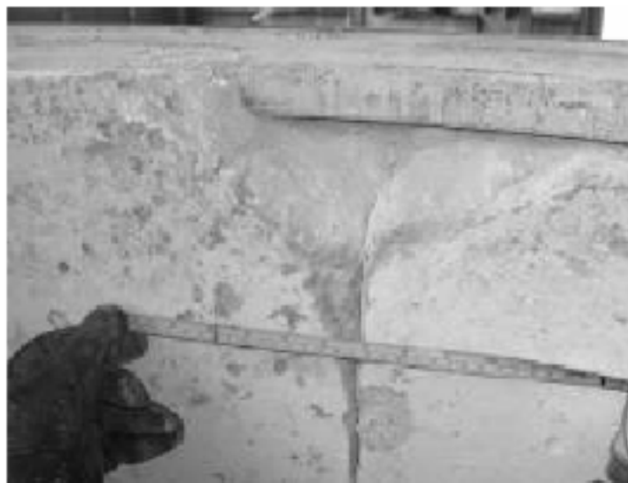
Figura 10: Desgaste em concreto refratário devido a erosão
