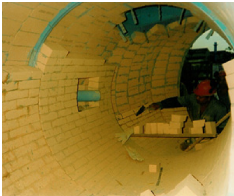
Fig. 3 - Chaminé de Tijolos Refratário
