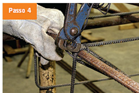
Figura 9 - Amarração dos estribos às barras de aço Fonte: Revista EQUIPE DE OBRA
