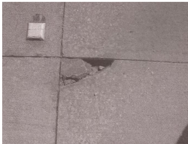
Figura 19 - Trinca Diagonal - Atraso no corte das juntas. (Silva, 2008)
