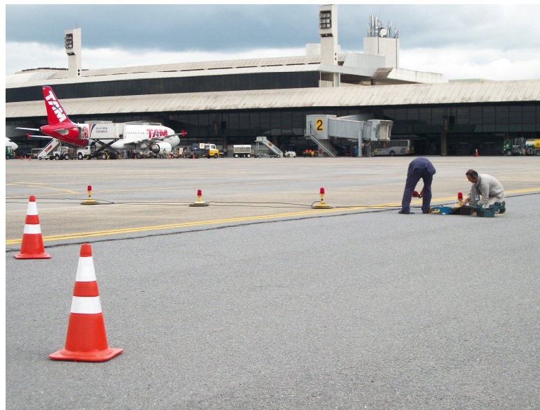
Figura 50 - Sinalização vertical (balizamento de pista) de interdição da taxiway FOX-2.
