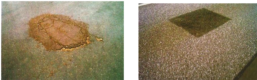
Figura 34 – Remendos (a) mal executado e (b) bem executado. (Bernucci, 2007)
