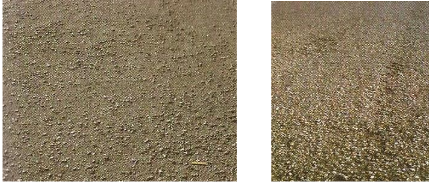
Figura 32 - (a) Desgaste e (b) desagregação decorrentes da falta de aderência ligante-agregado ou da presença de água nos vazios das camadas. (Bernucci, 2007)
