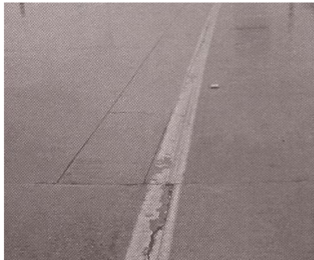
Figura 24 - Trincas transversais nas placas de concreto. (Silva, 2008)
