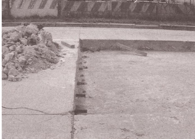
Figura 20 - Trinca transversal - Desalinhamento das barras. (Silva, 2008)
