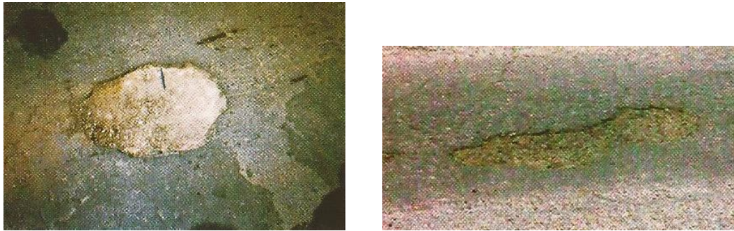
Figura 33 - Panelas causadas por deficiências na compactação, umidade excessiva nas camadas inferiores ou segregação. (Bernucci, 2007)
