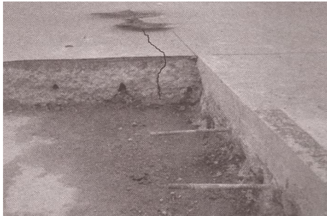
Figura 18 - Trinca longitudinal - Corte pouco profundo. (Silva, 2008)
