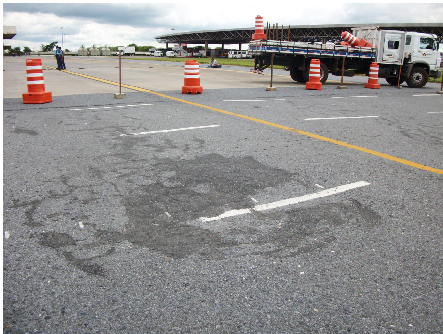
Figura 38 - Depressão e trincamento – Pista FOX-2 AITN.
