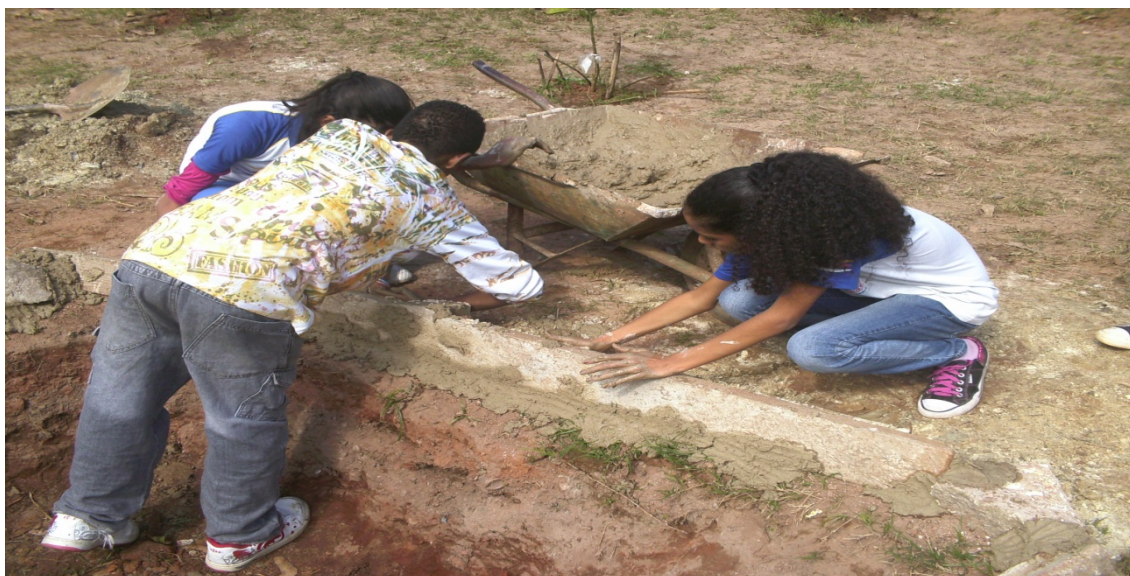
Imagem III - Compactação da “composteira” do lado de fora com argila. Fonte: Dados da pesquisa
