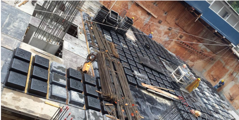
Figura 36: Colocação das cubetas plásticas da laje do teto do 2º subsolo Fonte: Construtora Caparaó, 2013
