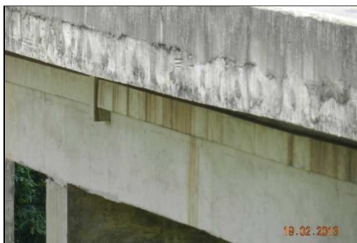
(e) Marcas de escoamento d'água na face lateral da viga caixão
