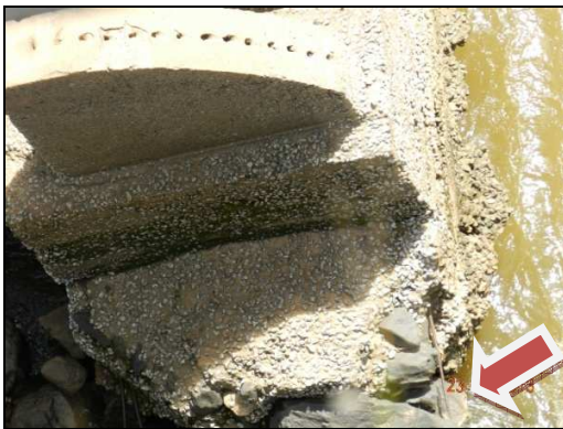
(e) Processo erosivo no concreto do bloco do pilar P3 e exposição de armaduras
