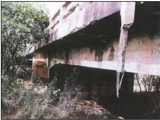
(e) Guarda-corpos destruídos, sinais de infiltração na longarina.
