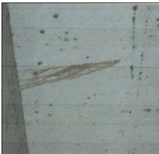
(k) – Infiltração e sinais de corrosão na laje na sua face inferior.
