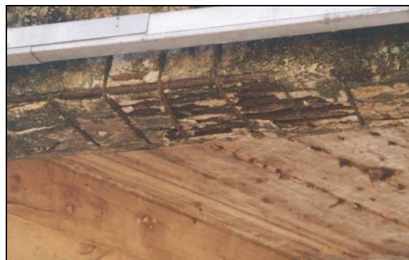
(f) - Armadura da longarina exposta em processo corrosivo.
