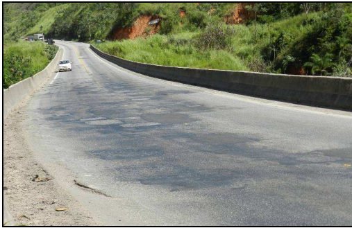
(c) Presença de diversos pontos de serviços de tapa buraco na pista – ondulações e irregularidades no pavimento. Lado Governador Valadares
