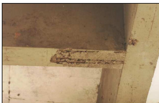
(c) – Transversina com exposição e corrosão da armadura.
