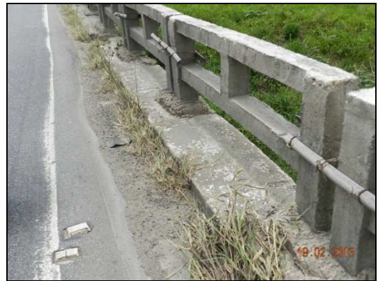
(d) Depósito de material e presença de vegetação no encontro da pista com o guarda-rodas
