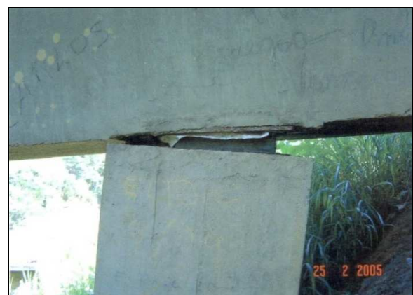
(b) Deslocamento e rotação do pilar 1. Sentido Belo Horizonte - Ipatinga
