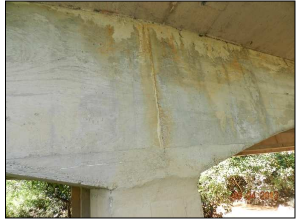
(j) Marca d'água proveniente da laje do balanço atingindo a longarina.
