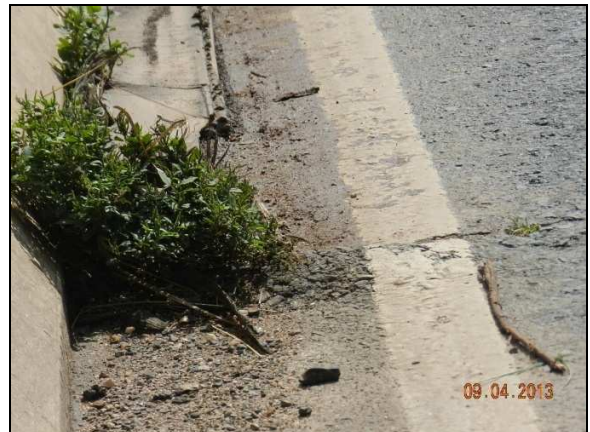
(f) Vista trinca transversal ao pavimento no lado esquerdo da ponte. Lado de Belo Horizonte.
