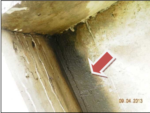
(g) Marcas de infiltração com lixiviação na interface do encontro com a estrutura da ponte. Fissura com 8 mm de abertura – lado de Belo Horizonte.
