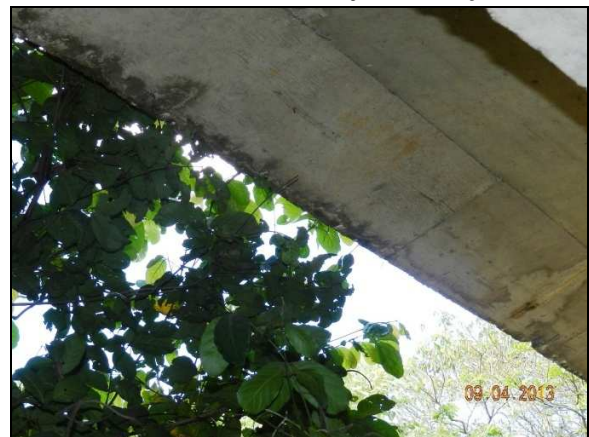
(h) Vista inferior da laje do balanço – Marcas d'água e erosão em pontos da quina da laje ao longo da sua extensão.
