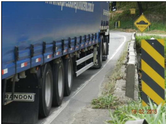
(c) Desalinhamento e desaprumo dos guarda-corpos
