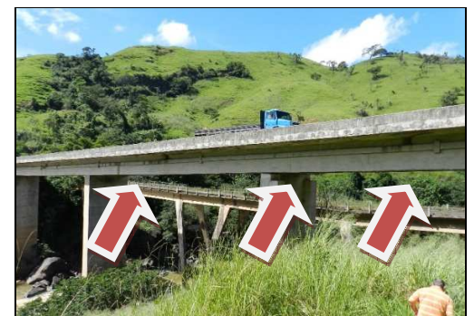
(g) Marcas de escoamento d'água na face lateral da viga caixão
