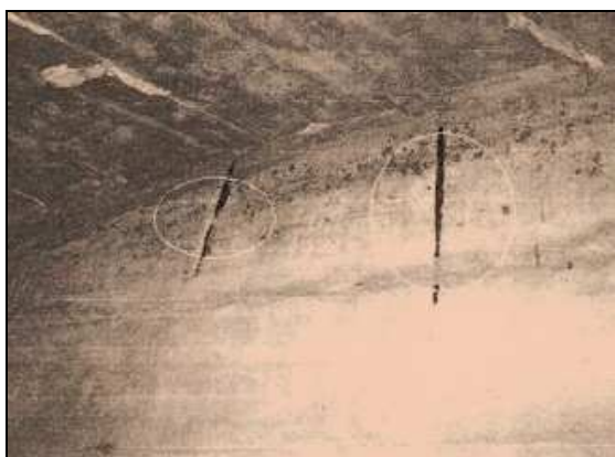
(g) - Corrosão em estribos na longarina a direita. Sentido governador Valadares – Belo Horizonte
