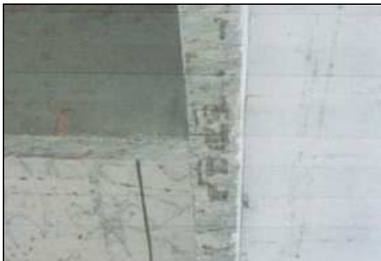
(i) – Exposição e corrosão das armaduras. Longarina e transversina à esquerda. Extremo Bela Vista de Minas. (sentido Governador Valadares – Belo Horizonte).
