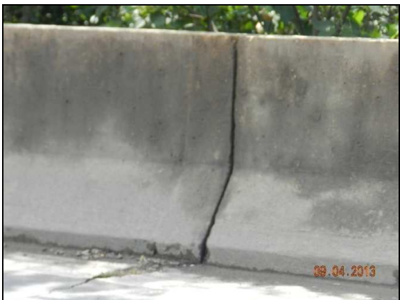
(g) Vista da trinca transversal ao pavimento do lado direito da ponte. Lado de Belo Horizonte.
