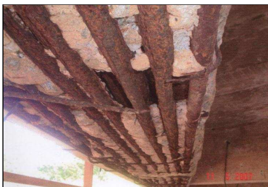
(a) Vista das armaduras da longarina mais afetada localizada a montante.
