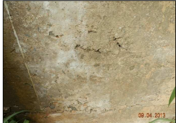
(o) Falhas de concretagem no encontro do lado de Belo Horizonte
