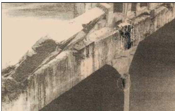
(e) – Escorrimento indevido da água e corrosão da armadura no topo do pilar. Guarda-corpos destruídos parcialmente.
