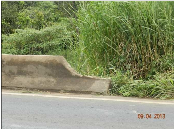
(i) Barreira New Jersey com determinada área destruída. Lado de Curvelo.
