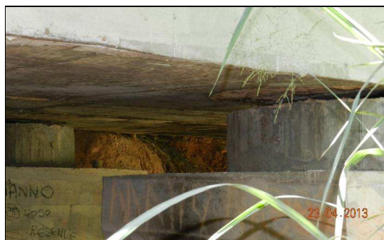
(p) Vista da região dos aparelhos de apoio dos pilares P6 e P7.
