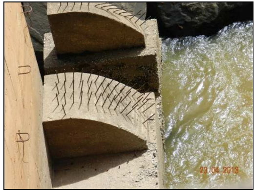
(d) Processo erosivo no concreto do bloco do pilar P3
