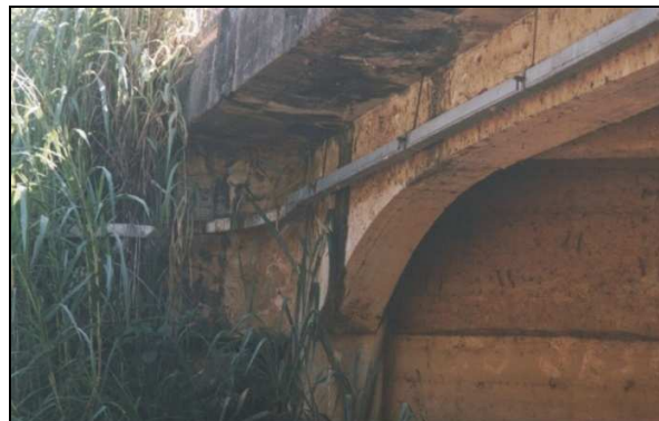
(b) - Marcas de água na laje em balanço e na longarina, proveniente do pavimento.
