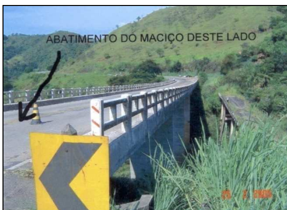
(a) Vista geral da ponte com identificação do local do abatimento do maciço
