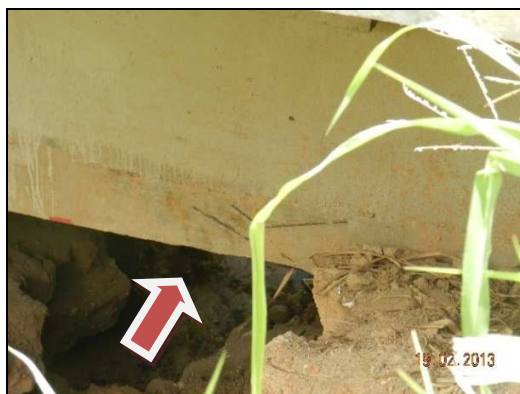
(h) Armações expostas no encontro no extremo de Governador Valadares. Lado esquerdo no sentido Governador Valadares – Belo Horizonte
