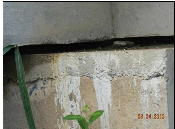
(d) Detalhe da regularização do encontro – falhas de concretagem – lado de Curvelo.
