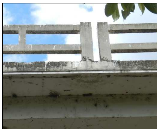
(d) Encontro das colunas do guarda-corpo com a laje do tabuleiro. Sinais de desgaste da estrutura.
