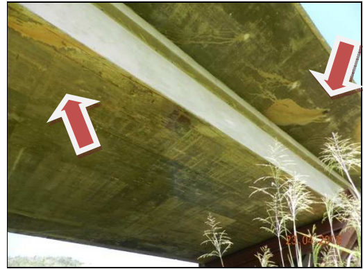
(b) Vista inferior do tabuleiro mostrando região com exposição de armadura na face inferior da viga caixão. Marcas de escoamento d'água na saída do dreno da laje em balanço. Lado Belo Horizonte
