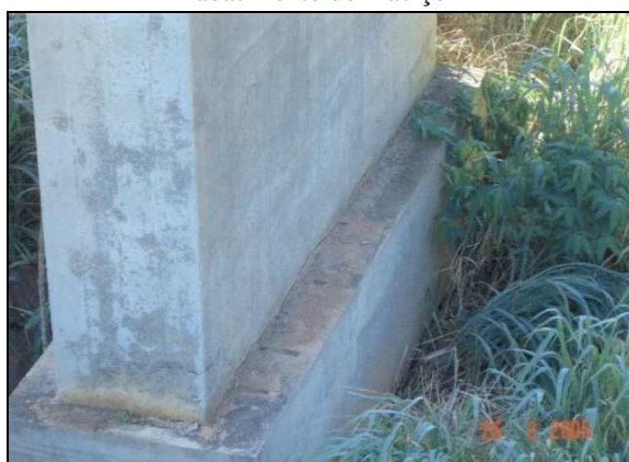
(c) Fissura entre o pilar 2 e o bloco. Sentido Belo Horizonte - Ipatinga
