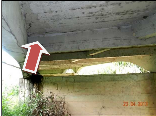
(a) Vista inferior do tabuleiro. Manchas brancas na superfície e fungos localizados nas juntas das antigas formas de concretagem.
