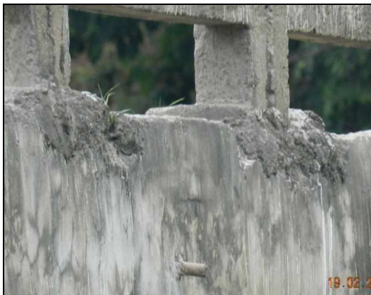
(e) Degradação do concreto no encontro das colunas dos guarda-corpos com a laje do estrado
