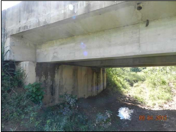
(a) Marcas de infiltração no encontro do lado de Curvelo.
