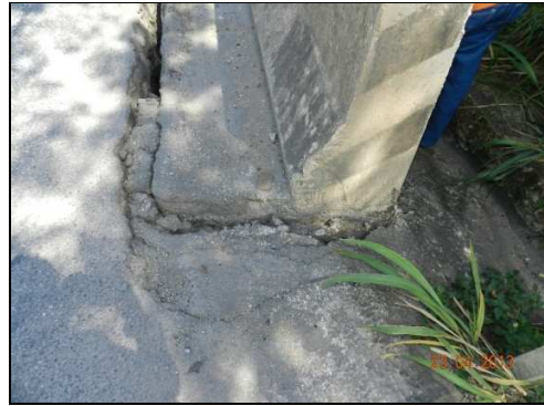
(j) Vista da trinca entre a pista de rolamento da rodovia e o encontro do extremo Governador Valadares. Lado direito no sentido Governador Valadares – Belo Horizonte
