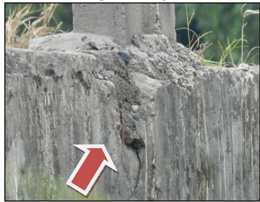
(f) Degradação do concreto com exposição de armadura no encontro das colunas dos guarda-corpos com a laje do estrado.
