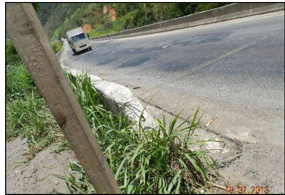
(f) Barreira com pequena área danificada. Lado Governador Valadares
