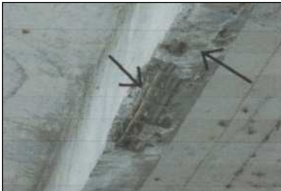
(g) – Exposição e corrosão das armaduras. Longarina à direita extremo Bela Vista de Minas. (sentido Governador Valadares – Belo Horizonte).
