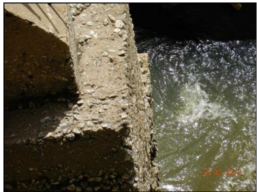
(f) Detalhe do processo erosivo
