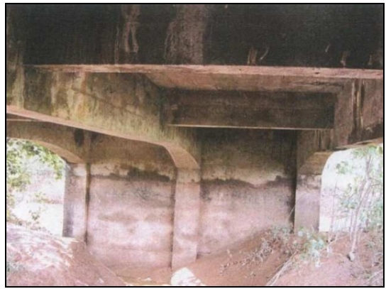
(f) Sinais de infiltração e lixiviação na parte inferior da laje e nas vigas.
