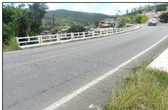
(b) Pista com trincas transversais no pavimento. Lado Belo Horizonte
