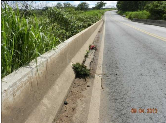
(c) Dreno obstruído com presença de vegetação
