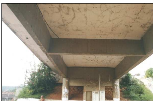
(a) - Vista inferior do tabuleiro com sinais de infiltração.
