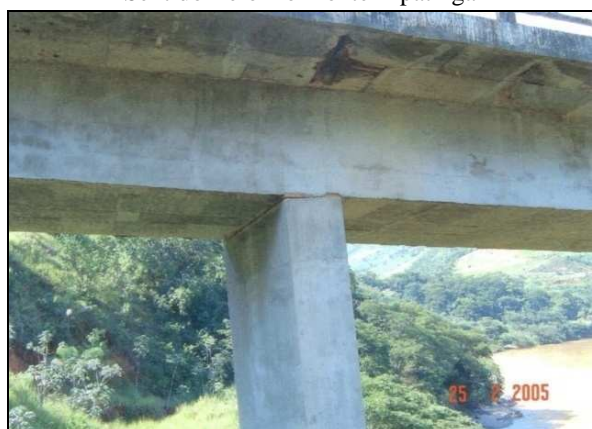
(d) Inclinação no pilar central devido a deslocamento do tabuleiro
