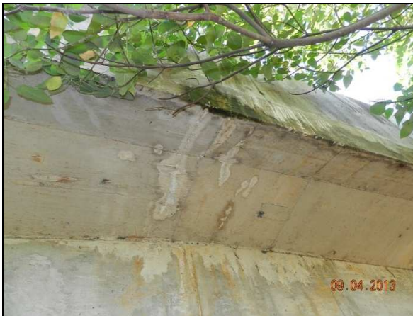
(g) Vista inferior da laje do balanço com manchas de infiltração que registram a percolação d'água.
