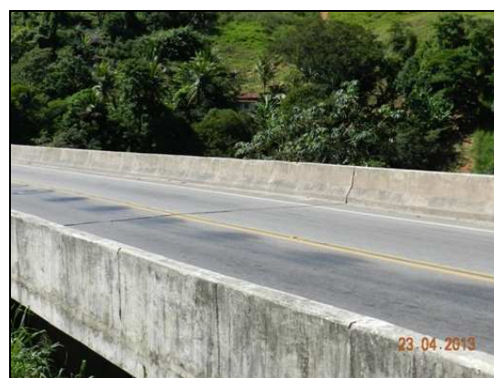
(b) Vista da pista com regiões isoladas de serviços de tapa buraco. Lado Belo Horizonte
