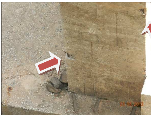
(g) Exposição das armaduras próximo a base no pilar P3
