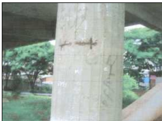
(m) – Pilar com armaduras expostas e em processo de corrosão.
