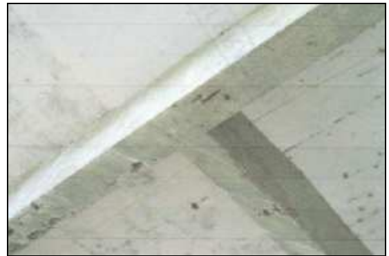
(h) – Exposição e corrosão das armaduras. Longarina e transversina à direit. Extremo Bela Vista de Minas. (sentido Governador Valadares – Belo Horizonte).
