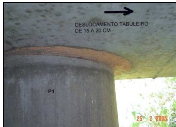
(f) Deslocamento de 20 cm no pilar 6 em relação ao tabuleiro. Lado Ipatinga da ponte.
