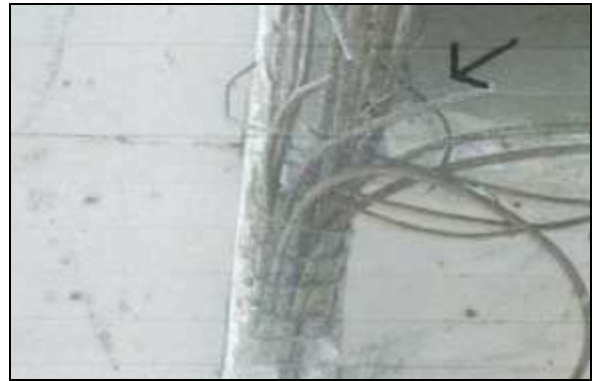
(d) – Ruptura das armaduras da primeira camada. Longarina à direita. Extremo Belo Horizonte. (sentido Governador Valadares – Belo Horizonte)
