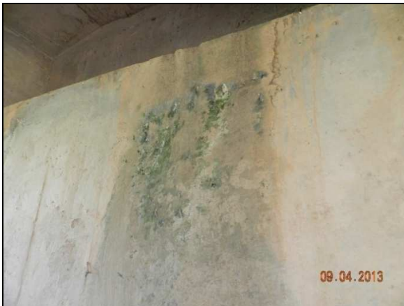
(c) Detalhe das marcas de infiltração com presença de lodo na parte central do encontro do lado de Curvelo.
