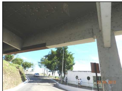
(f) Parte inferior da laje em vão próximo ao lado Belo Horizonte com eflorescências inclusive nas vigas e na estrutura do reforço da longarina.
