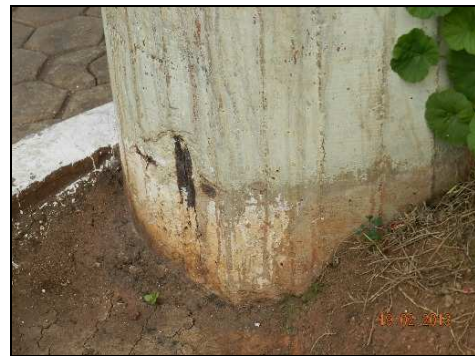
(l) Armadura exposta na base de pilar.
