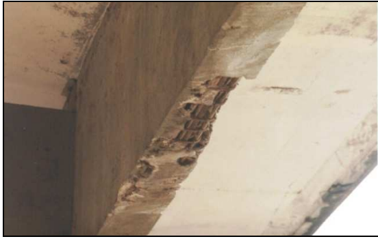
(e) – Longarina com trecho em avançado processo corrosivo e com buracos na estrutura de concreto.
