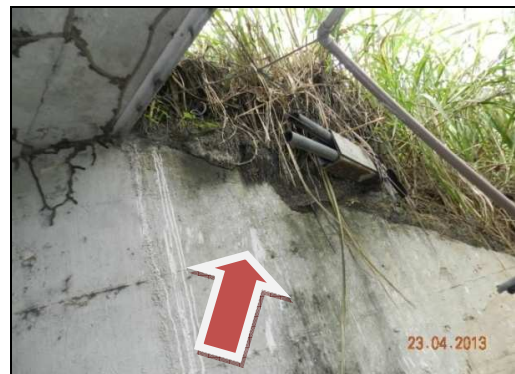
(b) Marcas de infiltração, vegetação densa com parte do encontro rompido no lado Governador Valadares
