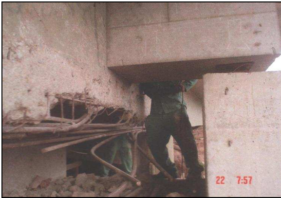
(c) – Vista do sistema de elevação do vão (sentido Governador Valadares – Belo Horizonte)
