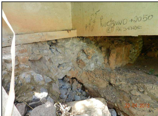
(e) Rolamento do material da base de estabilização do encontro no extremo Governador Valadares. Lado direito no sentido Governador Valadares – Belo Horizonte
