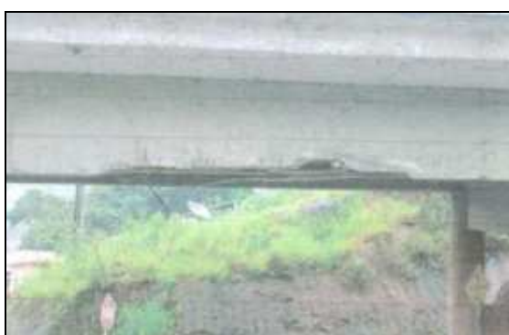
(a) – Vista lateral da longarina mais afetada. Longarina à direita. Extremo Belo Horizonte. (sentido Governador Valadares – Belo Horizonte)
