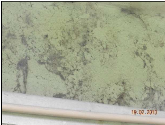
(c) Vista da face lateral da longarina a montante. Depósito de material pulverulento e ninhos de aranhas.
