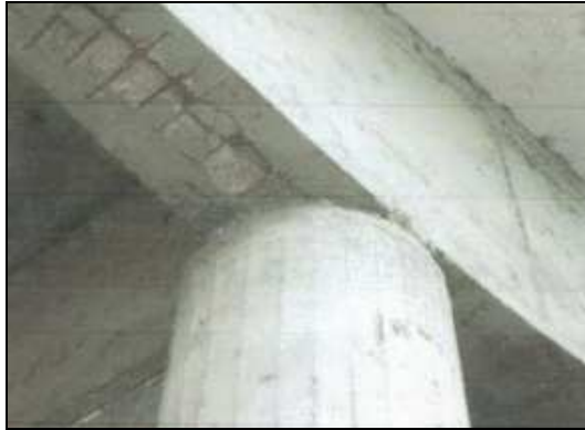
(e) – Exposição e corrosão das armaduras. Longarina à direita. Extremo Belo Horizonte. (sentido Governador Valadares – Belo Horizonte)
