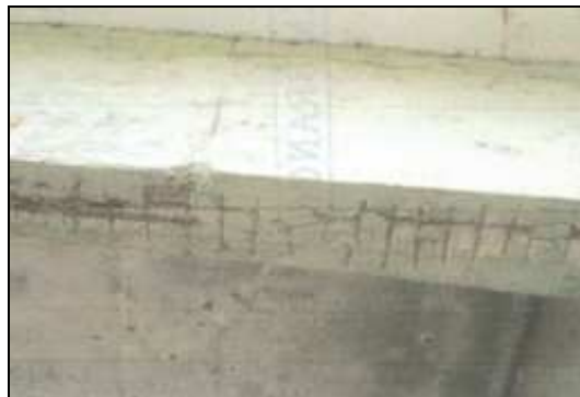
(j) – Exposição e corrosão das armaduras. Longarina e transversina à esquerda. Extremo Bela Vista de Minas. (sentido Governador Valadares – Belo Horizonte).
