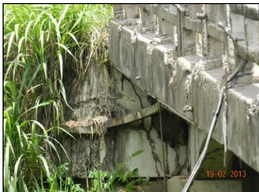
(a) Marcas de infiltração, ninho de praga e vegetação densa no encontro lado Belo Horizonte
