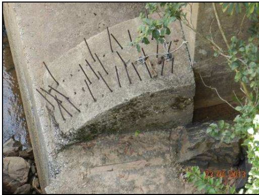
(i) Processo erosivo no concreto do bloco do pilar P4
