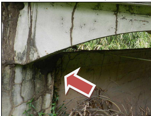
(e) Deslocamento da longarina em relação ao pilar.
