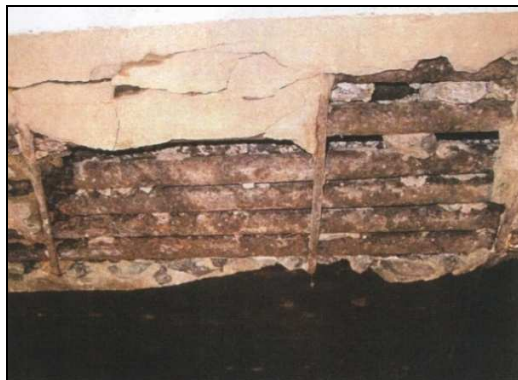
(j) – Armação exposta em longarina externa com processo corrosivo adiantado e deslocamento do concreto.
