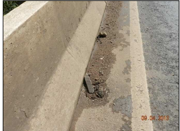
(d) Dreno obstruído
