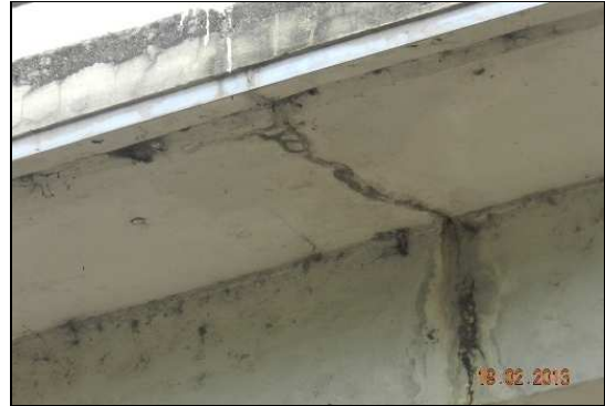
(b) Escorrimento de água oriunda da pista alcançando a parte inferior do balanço e a longarina
