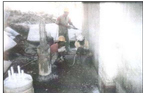
(d) Perfuração para colocação de chumbadores nos pilares e apicoamento da cortina
