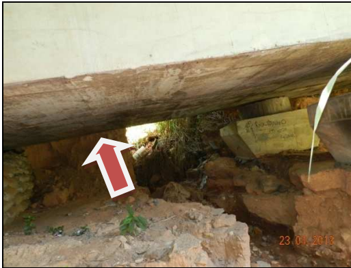
(a) Vista inferior do tabuleiro mostrando região com exposição de armadura na face inferior da viga caixão. Lado Governador Valadares
