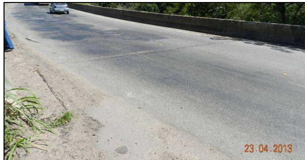
(k) Vista da trinca entre a pista de rolamento da rodovia encontro do extremo Governador Valadares. Lado esquerdo no sentido Governador Valadares – Belo Horizonte
