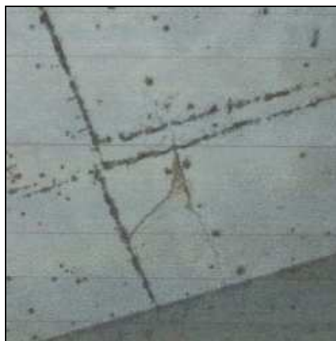
(l) – Infiltração e sinais de corrosão na laje na sua face inferior.
