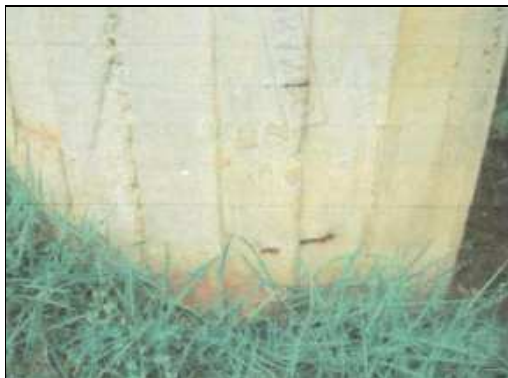
(o) – Pilar com armadura exposta e em processo de corrosão.
