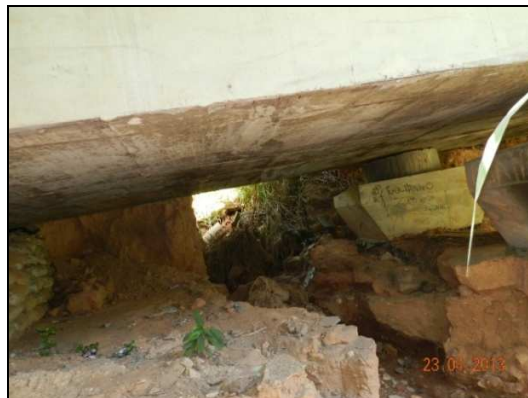
(f) Degrau resultante do carreamento do material de reaterro no extremo Governador Valadares. Lado direito no sentido Governador Valadares – Belo Horizonte
