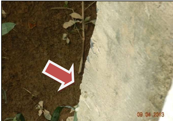
(n) Falhas de concretagem no encontro do lado de Belo Horizonte
