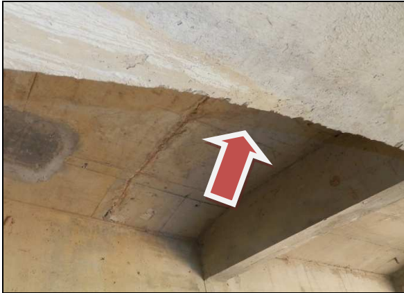
(c) Pequenas falhas de concretagem nas quinas das vigas.
