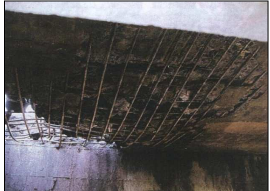
(d) Vista inferior do buraco da laje
