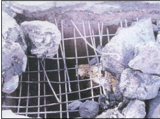
(c) Vista superior do buraco da laje
