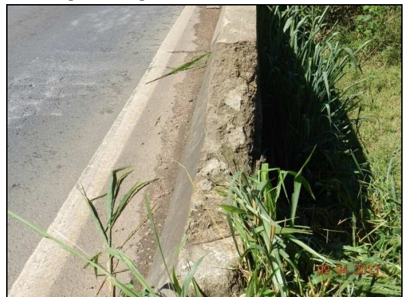
(h) Barreira New Jersey parcialmente destruída. Lado de Curvelo.
