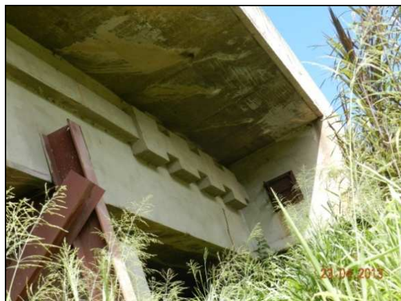
(b) Vista lateral do vão antigo e da ausência de acesso lateral para a vistoria dos elementos da mesoestrutura e da infraestrutura do vão adicional.
