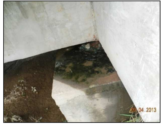
(j) Depósito de água na superfície superior do encontro – lado de Belo Horizonte
