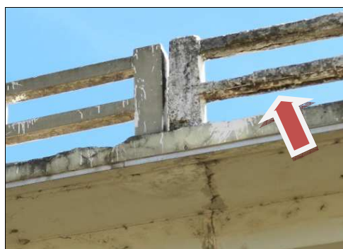
(f) Exposição das armaduras e concreto deteriorado no guarda-corpo.
