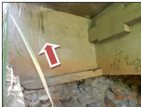
(d) Marcas de escoamento de água no encontro do lado Governador Valadares.
