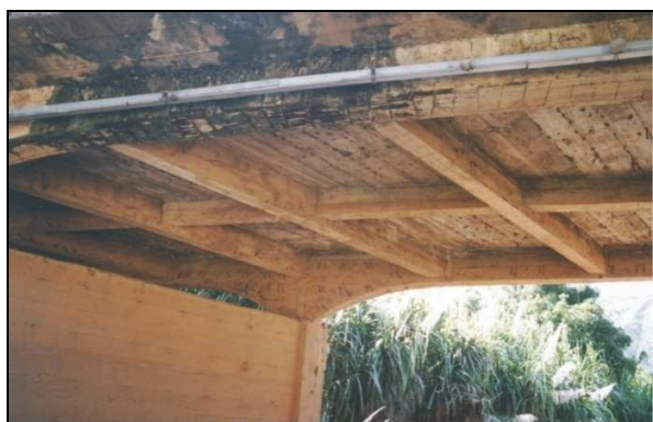
(c) - Longarina com armadura exposta já com processo corrosivo.
