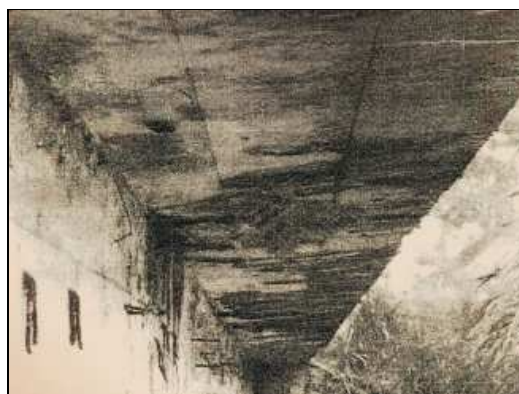
(b) – Laje em balanço com marcas de escoamento de água e eflorescências.
