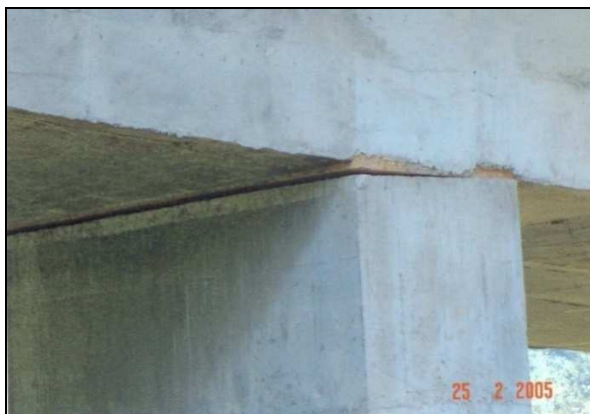
(e) Deslocamento de 30 cm do pilar 5 em relação ao tabuleiro. Lado Ipatinga da ponte.
