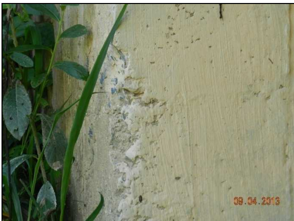
(e) Falha de concretagem no encontro do lado de Curvelo.
