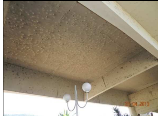
(h) Parte inferior da laje em vão próximo ao lado Belo Horizonte com marcas de infiltração.
