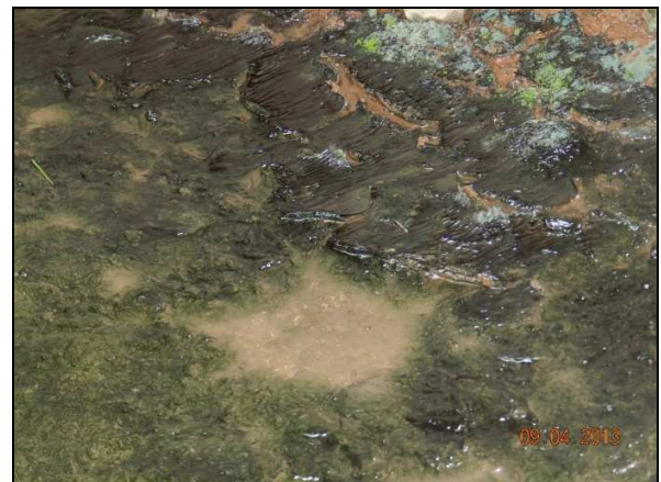
(m) Depósito de água com presença de fungos na superfície superior do encontro do lado de Belo Horizonte. Região dos aparelhos de apoio.
