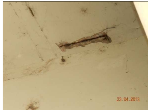
(j) Armadura exposta na face inferior da laje, em vão central do viaduto.
