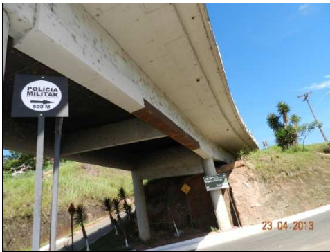
(i) Infiltração e pontos de corrosão na face inferior da laje.
