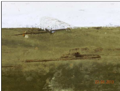
(c) Detalhe da exposição de armaduras na face inferior da viga caixão.
