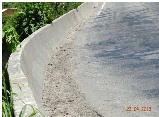
(e) Depósito de material na região entre a pista e a barreira de segurança. Ausência da sinalização horizontal de delimitação da pista.
