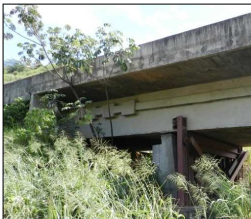
(a) Vista lateral do vão antigo e da ausência de acesso lateral para a vistoria dos elementos da mesoestrutura e da infraestrutura do vão adicional.
