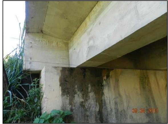
(b) Detalhe das marcas de infiltração no encontro do lado de Curvelo.
