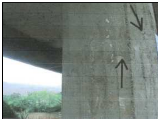
(n) – Pilar com falhas de concretagem
