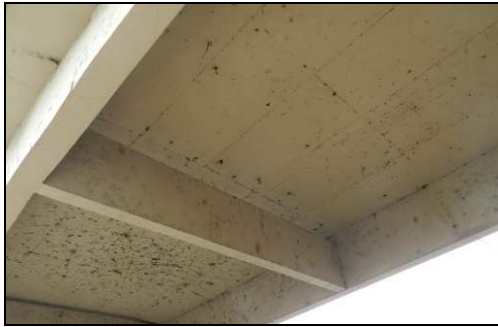
(c) Elementos do tabuleiro do lado Governador Valadares em bom estado. Presença de ninhos de aranha, retenção de sujeira e eflorescências no antigo encontro das formas de concretagem originais da obra
