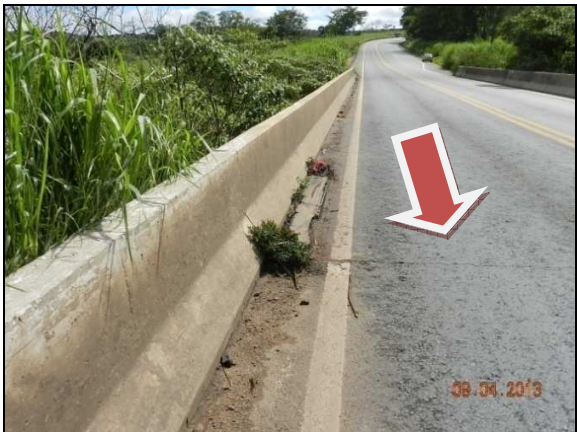
(e) Indicação da trinca transversal no pavimento. Lado de Belo Horizonte.
