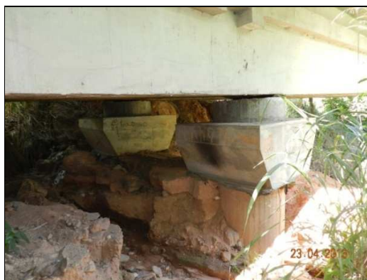
(g) Degrau resultante do carreamento do material de reaterro no extremo de Governador Valadares. Lado direito no sentido Governador Valadares – Belo Horizonte
