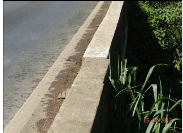
(j) Desalinhamento entre as estruturas da ponte e do encontro. Lado de Curvelo
