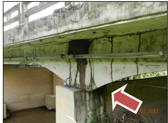
(d) Apoio com infestação e vista do deslocamento da longarina em relação ao pilar.
