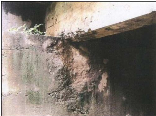
(g) Destruição dos aparelhos de apoio e ruptura do apoio do encontro.
