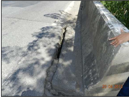
(i) Vista da trinca entre a pista de rolamento da rodovia e o encontro do extremo Governador Valadares. Lado direito no sentido Governador Valadares – Belo Horizonte
