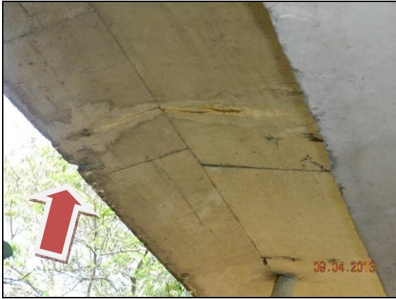
(i) Vista inferior da laje do balanço – Erosão em pontos da quina da laje e marca d'água atingindo a longarina.
