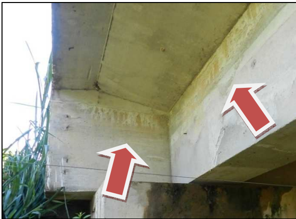
(k) Marca d'água proveniente da laje do balanço atingindo a longarina e a transversina do encontro.
