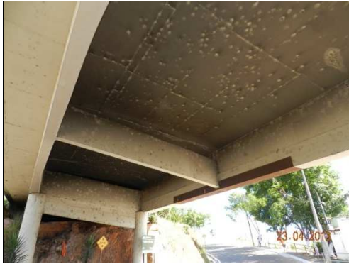
(g) Parte inferior da laje em vão próximo ao lado Belo Horizonte com marcas de infiltração inclusive nas vigas
