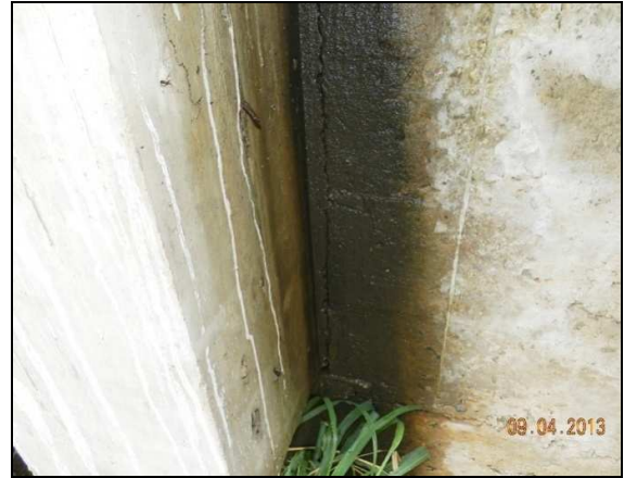
(h) Marcas de infiltração na interface do encontro com a estrutura da ponte. Fissura com 8 mm de abertura – lado de Belo Horizonte.
