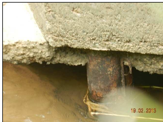
(d) Detalhe do processo erosivo na parte inferior do bloco de reforço e topo de estaca raiz exposta com marcas de oxidação.
