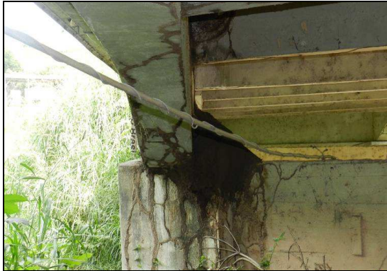
(g) Ninho de inseto avançando na região interna da ponte.
