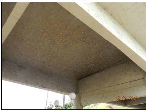
(e) Parte inferior da laje em vão próximo ao lado Belo Horizonte com eflorescências, inclusive nas vigas.
