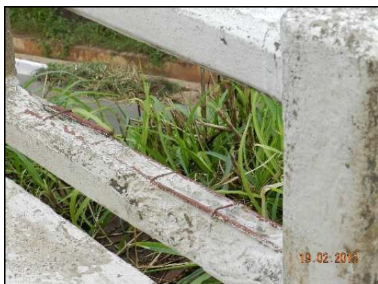
(c) Guarda-corpo com armação exposta .
