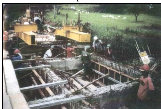
(d) Nova armação do reforço e fechamento dos painéis das formas das longarinas
