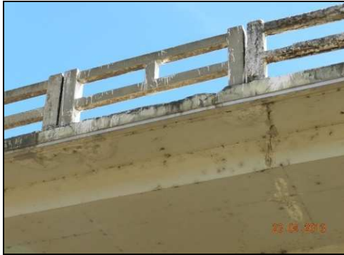
(a) Manchas provenientes do escoimento de água oriunda da pista alcançando a parte inferior da viga em balanço
