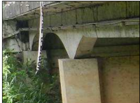
(d) Ausente espaçamento entre as longarinas e os pilares
