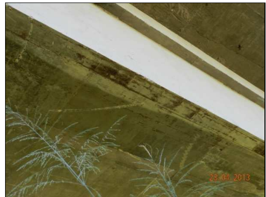
(d) Vista inferior do tabuleiro mostrando região com exposição de armadura na face inferior da viga caixão.
