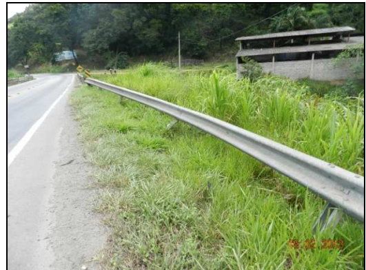
(h) Queda do trilho de segurança ("guard-rail").
