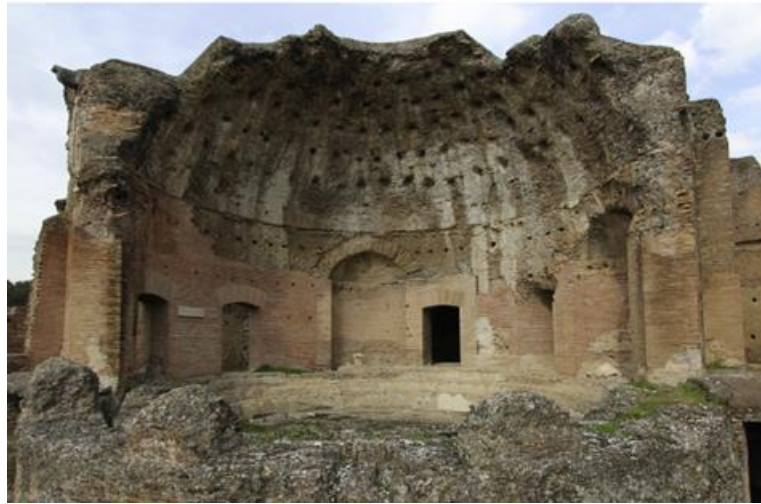
Figura 2 – Casa de banho de uma vila próximo a Roma. Ref. COLUMBU, S., ET al. , 2014.
