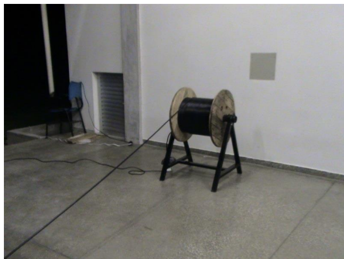
Figura C.2.8: Foto do carretel com 300 m de cabo elétrico alimentando o nobreak do módulo R_x .
