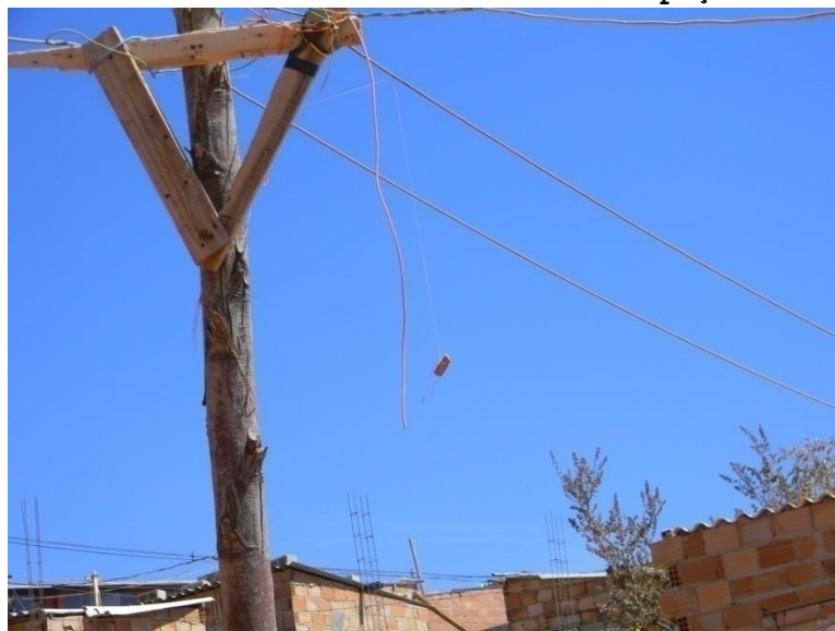
Figura 40- Gatos elétricos feitos nas ocupações urbanas
