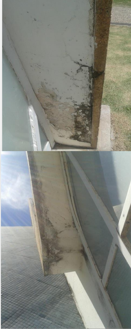
Figura 37: Abóbodas com revestimento com bolor, deslocamento e esfarelamento do revestimento.
