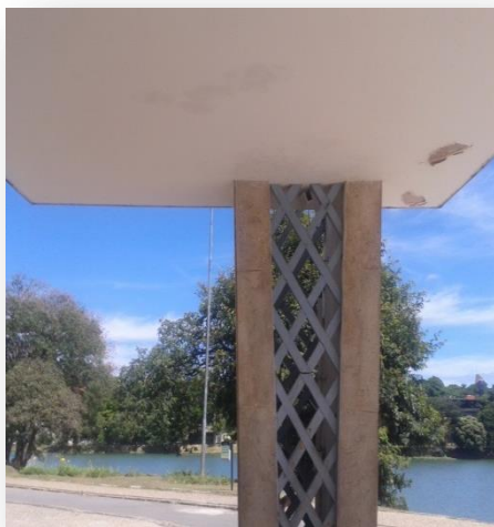
Figura 31: Encontro entre revestimento de gesso e estrutura metálica (oxidação).
