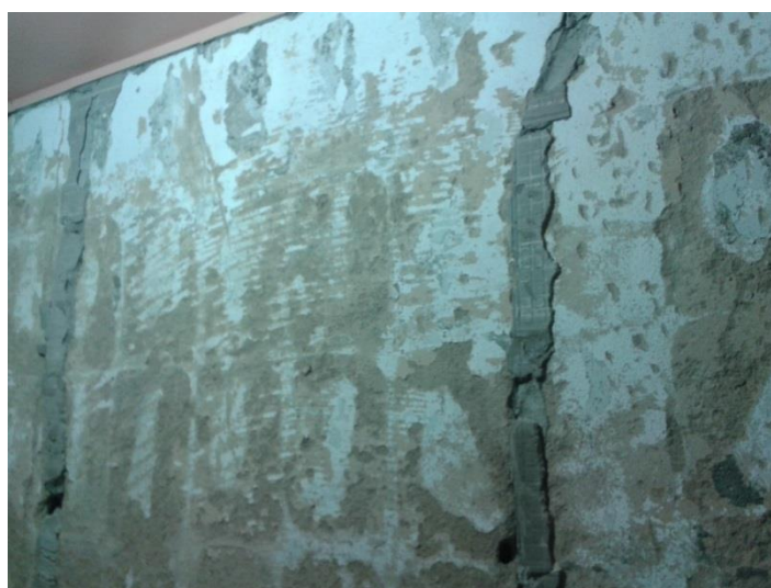
Figura 48: Base com limpeza mal executada.
