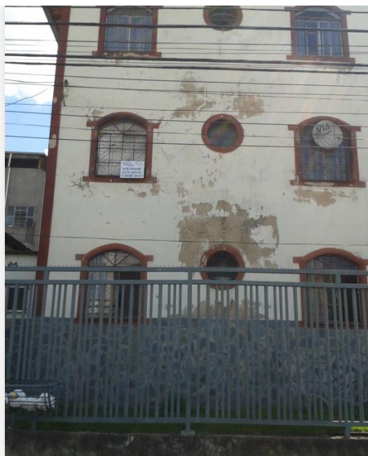
Figura 52: Degradação do revestimento em edificação residencial multifamiliar.
