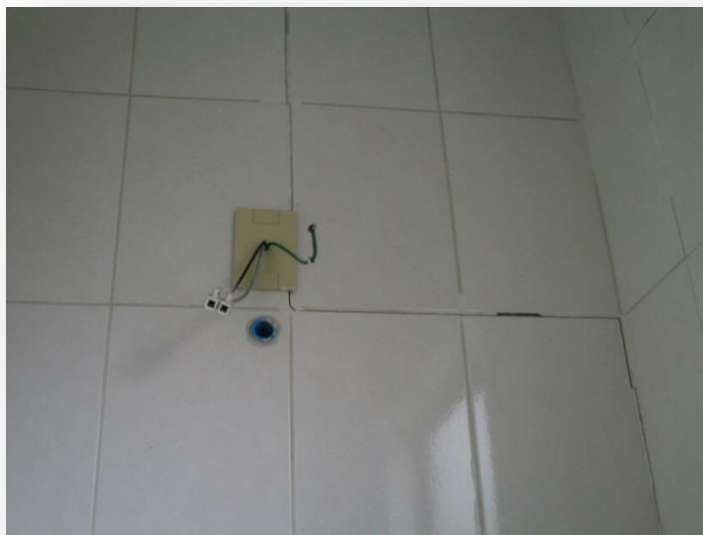
Figura 60: Deslocamento de revestimento cerâmico.
