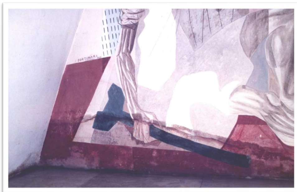
Figura 14: Deterioração interna devido à infiltrações. Fonte: Igreja da Pampulha Projeto e obra.
