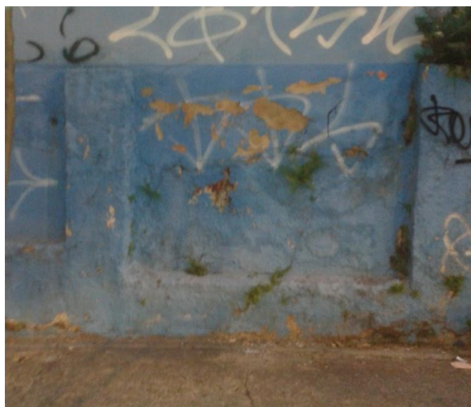
Figura 51: Muro com esfarelamento e surgimento de vegetação.
