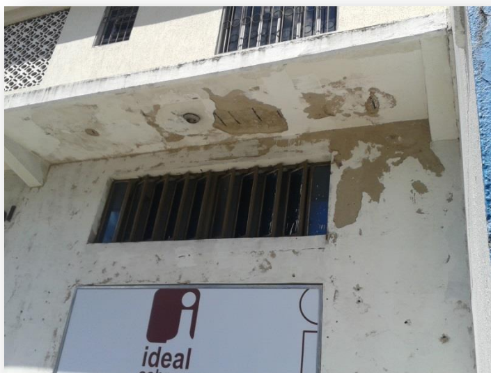
Figura 63: Descolamento de pintura, esfarelamento de reboco e armadura exposta em revestimento.
