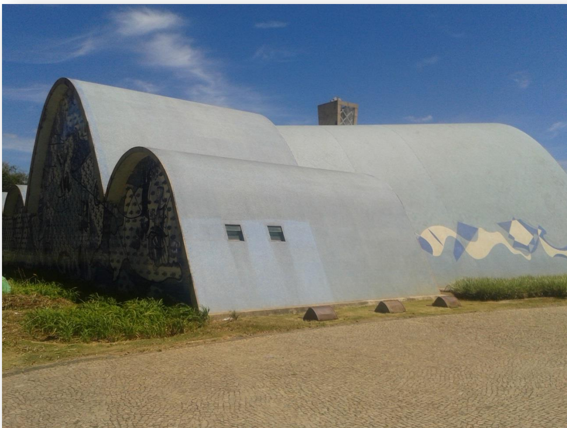
Figura 40: Acúmulo de poeira na superfície das pastilhas e rejuntamento indicando falta de manutenções periódicas.
