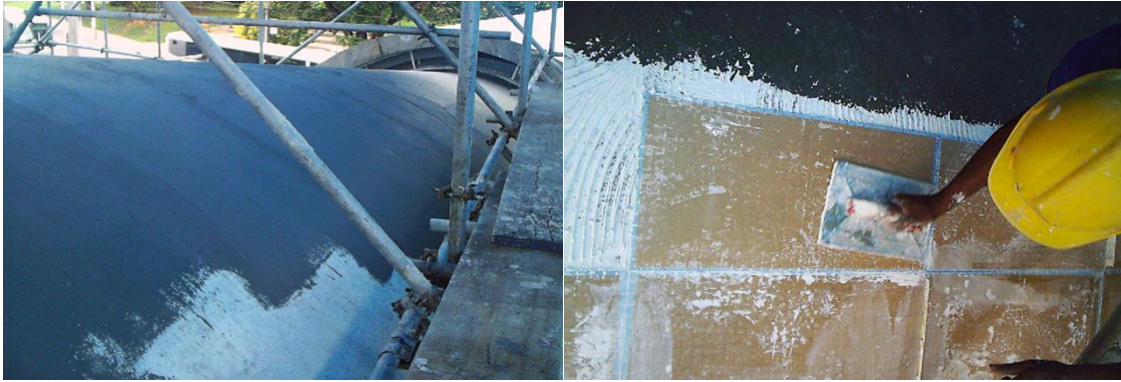
Figura 26: Acabamento superficial desempenado, cura úmida, impermeabilização com revestimento polimérico flexível de base cimentícia, aplicação de pastilhas.
