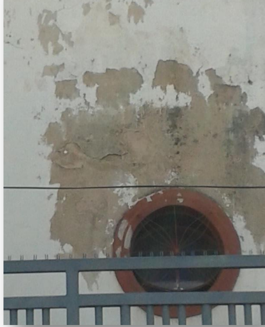
Figura 53: Concentração de patologias nas áreas próximas a janelas.
