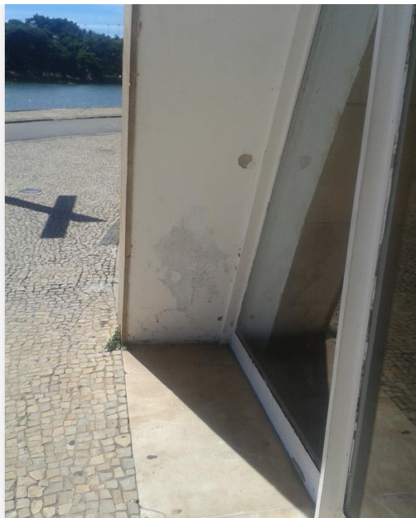
Figura 30:Revestimento em gesso liso com descolamento.
