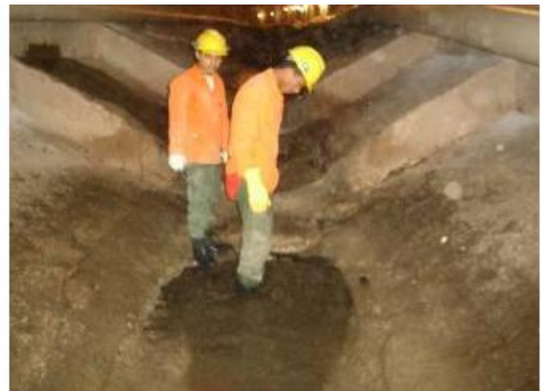
Figura 3-14 – Efeitos da cavitação em estruturas de concreto. (Fonte: Aguiar, 2014).
