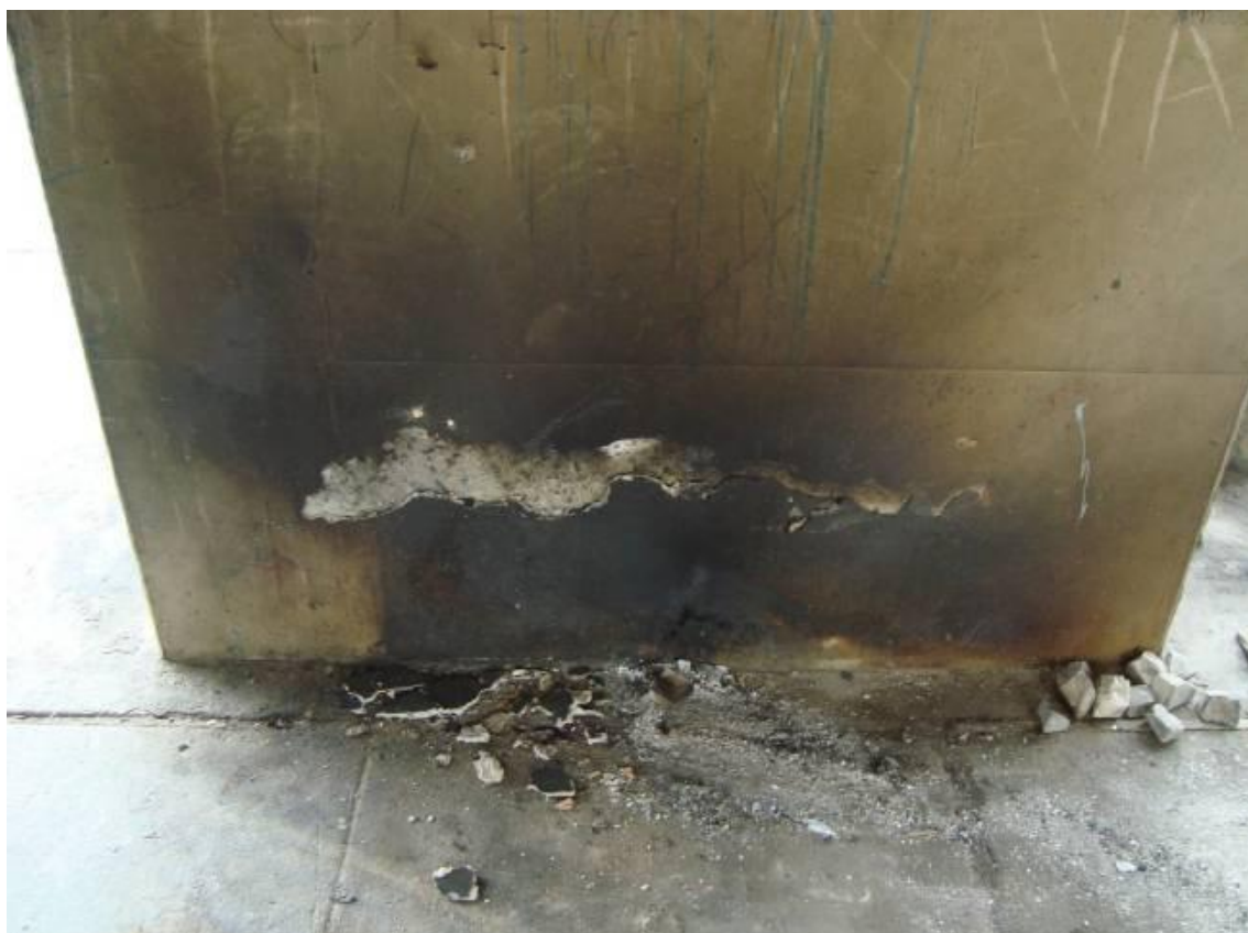
Figura 3-19 – Danos a um pilar devido ao fogo utilizado por moradores de rua. (Fonte: Aguiar, 2014).
