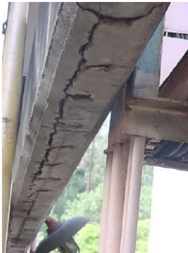
Figura 3-7 – Fissura em viga causada pela expansão dos óxidos gerados na corrosão. (Fonte: Aguiar, 2014).
