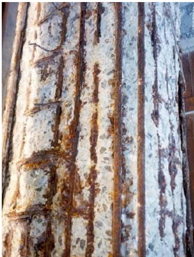
Figura 3-6 – Processo de deterioração em pilar sobre o mar. (Fonte: Aguiar, 2014).
