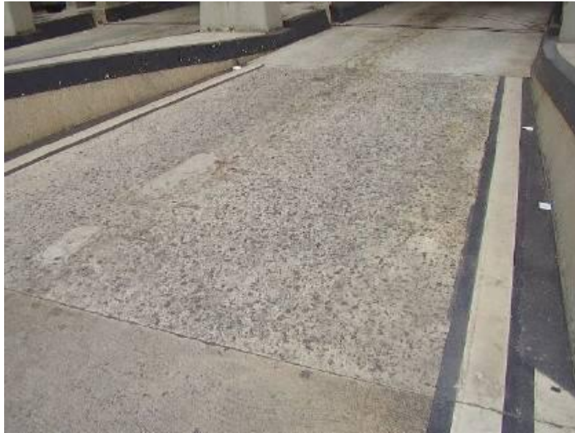
Figura 3-15 – Desgaste superficial em pavimento de concreto. (Fonte: Aguiar, 2014).
