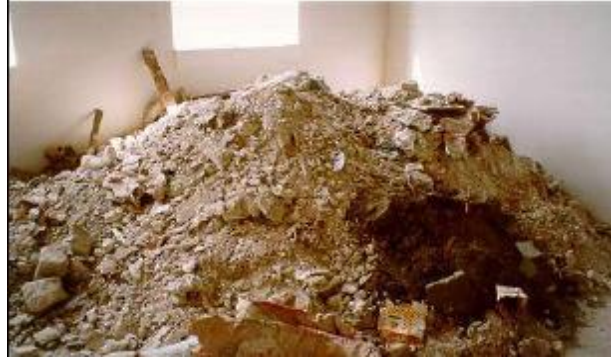
Figura 1 - Entulho gerado por reforma
