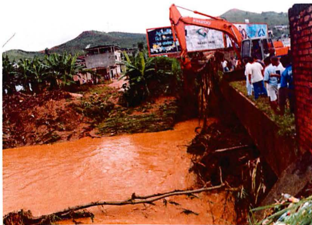
Foto 18: Destruição parcial da ponte que liga os bairros Limoeiro e Chácara Madalena, pelas enchentes de fevereiro de 2000
