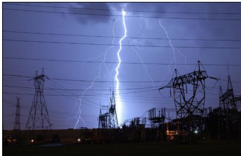
Figura 1 - Descargas Atmosféricas Típicas
