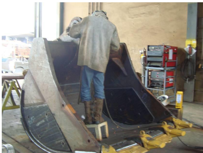
Figura 12 – Soldador utilizando degrau de metal para alcançar região mais alta do implemento.
