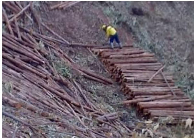
FIGURA 7: RISCO DE QUEDA - TRABALHADOR SOBRE TORETES DE MADEIRA
