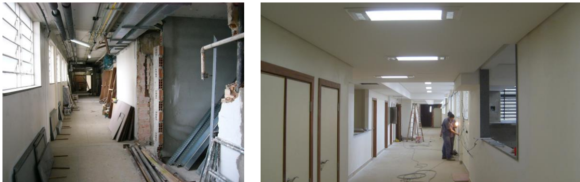
Figura 17: a) Obra da Neonatologia na fase de execução da infraestrutura junto ao teto; b) Finalização da obra na Neonatologia.
