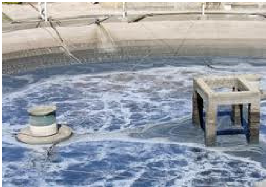
FIGURA 4 - Tanque de equalização Fonte: BELAFRANCA CURTUME, 2012.
