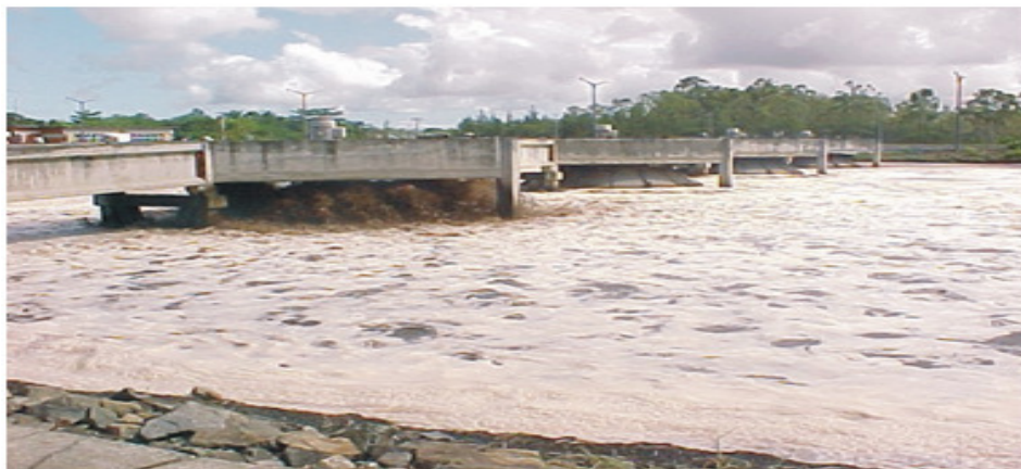
FIGURA 5 - Tanque de aeração em funcionamento
