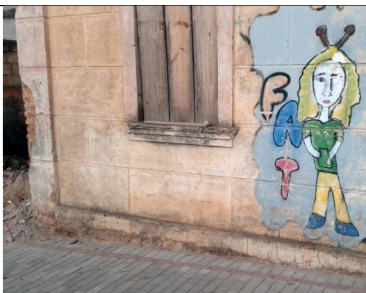
Fissuras e trincas na base da construção. Pichações na fachada
