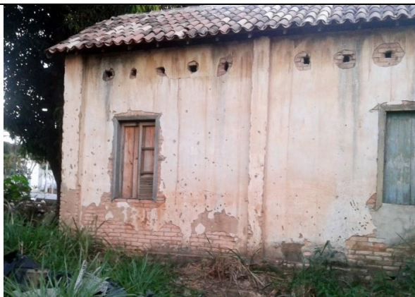
A argamassa do revestimento descolada da alvenaria.
