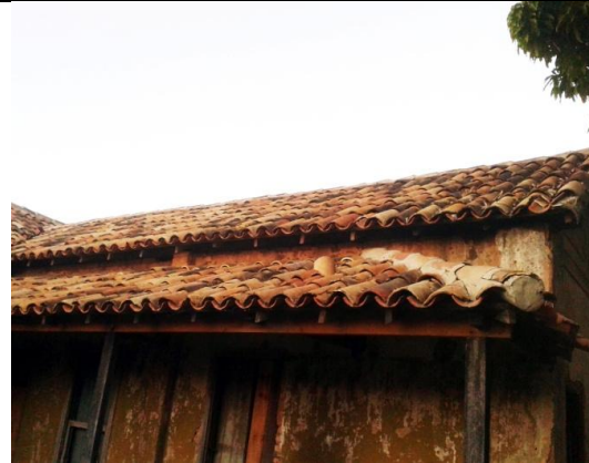
Telhado com manchas e telhas quebradas
