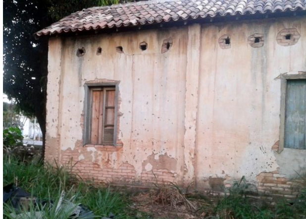
Figura 13 - Argamassa do Revestimento Descolada da Alvenaria.
