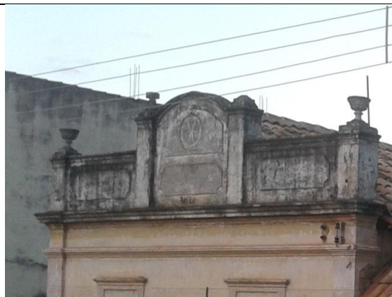
Manchas escuras na parte superior da fachada.
