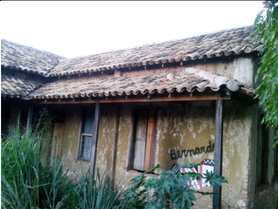
Descamação da tinta. Pichações na fachada.
