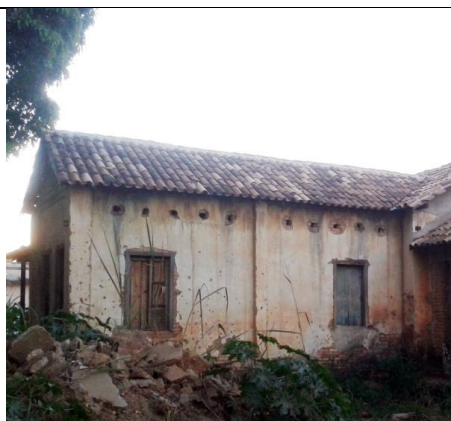
Manchas de escoamento na parte superior da fachada.
