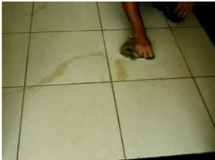
Figura 17 : Deterioração por produtos químicos
