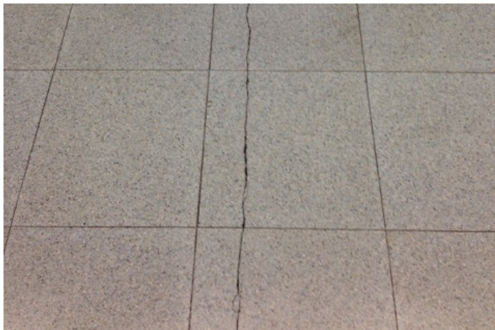
Figura 21 : Rachaduras de várias peças através da superfície cerâmica
