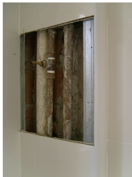
Figura 43 - Estrutura finalizada em área molhada com área de visita para registros (LABUTO, 2008).
