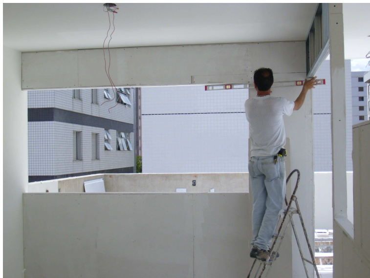
Figura 36 - Nivelamento entre janela e porta de gesso acartonado em estruturas de Drywall no Condomínio do residencial Antoni Gaudi em Belo Horizonte - MG (LABUTO, 2007)
