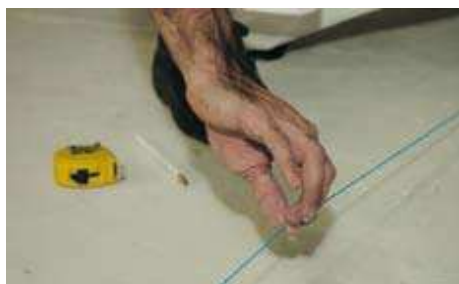
Figura 21 - Marcação do posicionamento das guias através de cordão ou fio traçante. (KNAUF, 2009)
