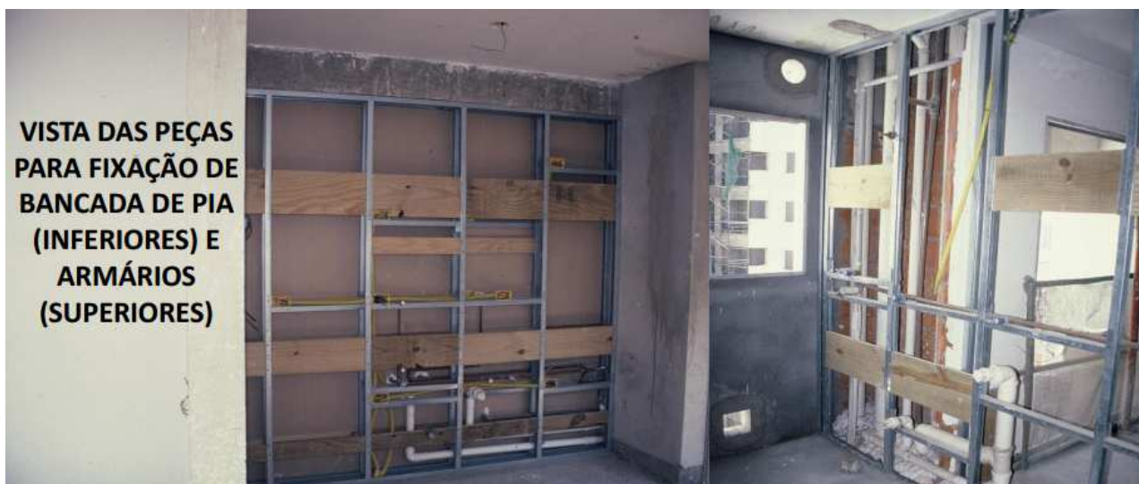
Figura 19 - Paredes em drywall com reforço estrutural para receber armários / pias e louças sanitárias. (MITIDIERI, 2013)
