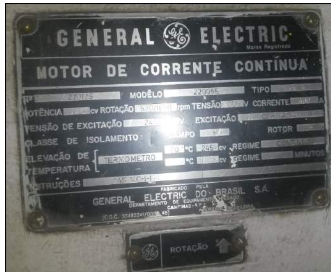
Figura 3.1: Dados de placa do motor da bobinadeira
