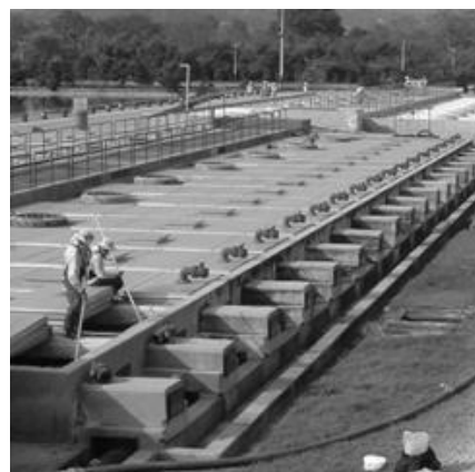
Figura 4.8 – Vista dos reatores UASB da ETE Rio Frio, em Bucaramanga na Colômbia.
