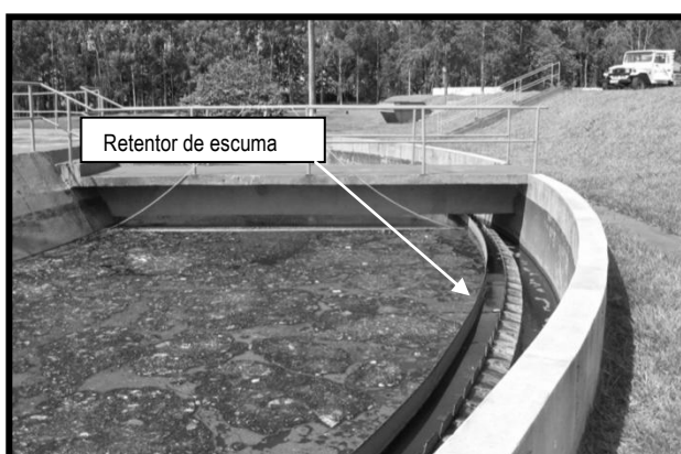
Figura 4.5 – Reator UASB com coleta do efluente em vertedores triangulares, com retentores de espuma. ETE – Itabira/MG.
