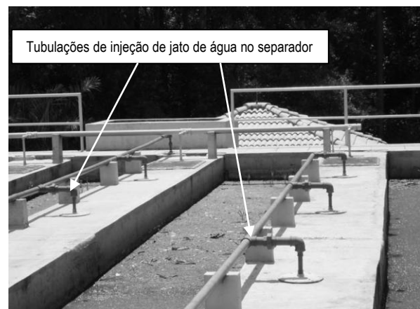
Figura 4.14 – Tubulação de injeção de jato de água no interior do separador trifásico. ETE – Matão/SP.
