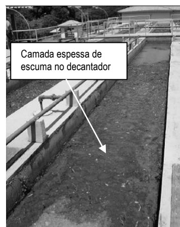
Figura 4.4 – Camada espessa de espuma formada no decantador do Reator UASB da ETE – Matão/SP, com coleta do efluente por tubos perfurados submersos.
