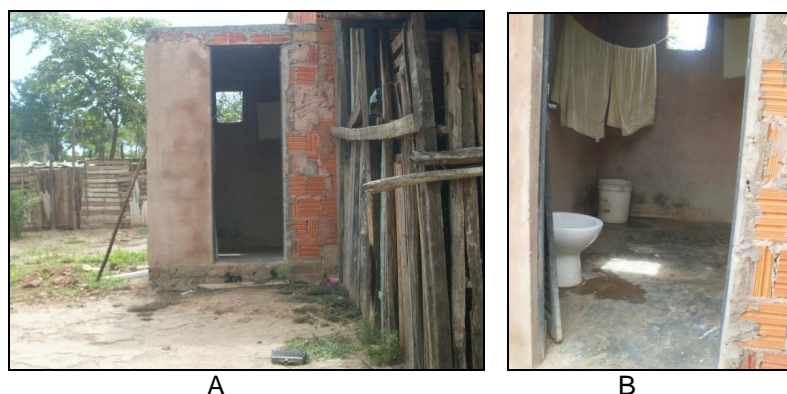
FIGURA 25 É A e B - Banheiro com vasos sanitários ligados a fossa negra, no Assentamento Estrela do Norte Fonte: TRABALHO DE CAMPO, 2010.
