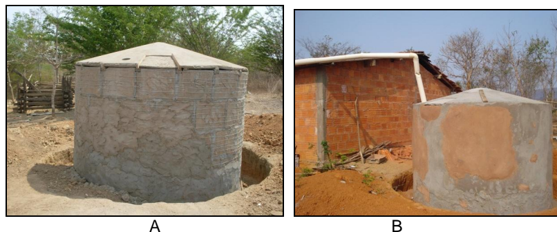
FIGURA 21 A e B - Cisterna de Placas para captação de água de chuva no Assentamento Estrela do Norte Fonte: TRABALHO DE CAMPO, 2010
